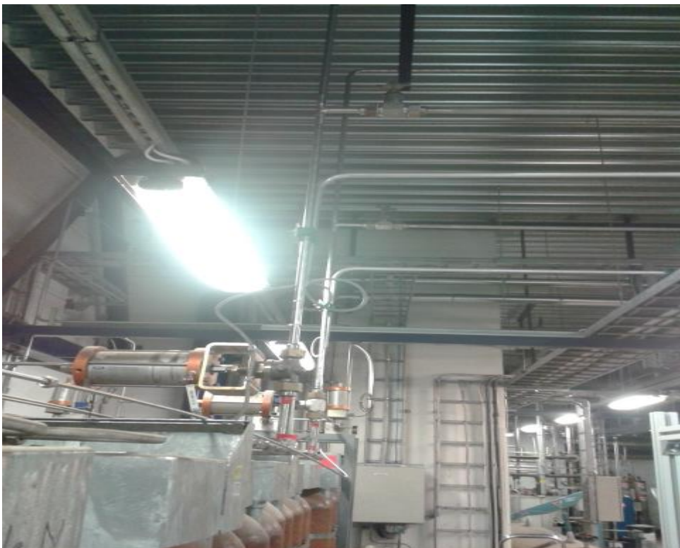
Kuva 10. T-haara He-N puskusta semiasemien kaasunsyöttölinjaan (Lindfelt 2016)
