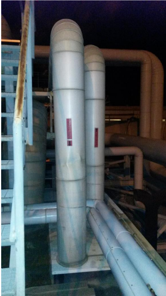
Kuva 9. Kaukolämpöputket Pyroflow-yhdyskäytävään katolta. (Ville Lahti)
