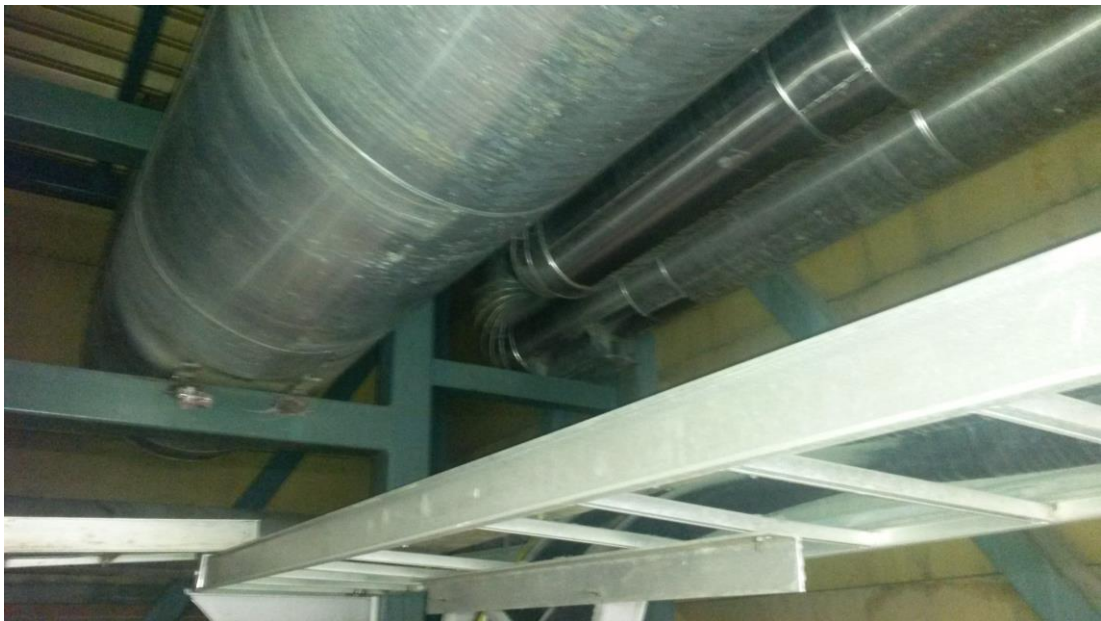
Kuva 10. Kaukolämpöputkien liityntäpaikka. (Ville Lahti)
