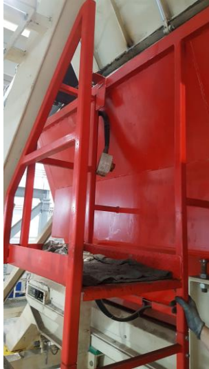
KUVA 24. Putkivalukoneen alempi siilo.
