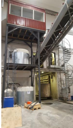
KUVA 8. Betoniaseman ohjauskeskus lattiatasolta katsottuna.
