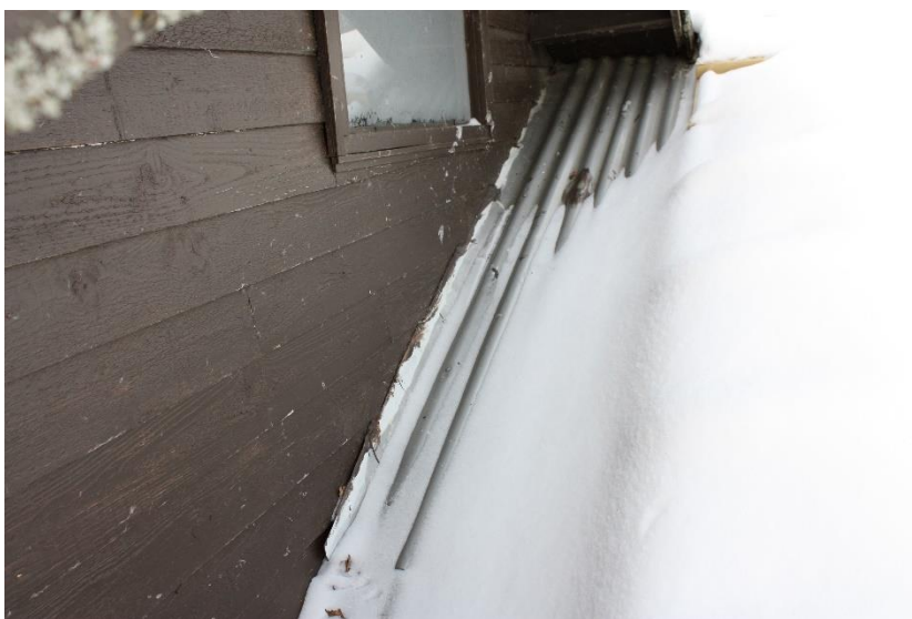
Kuva 69. Vesikatteen ja seinän liittymä. Pahemman vesivuodon estää todennäköisesti räystäs.
