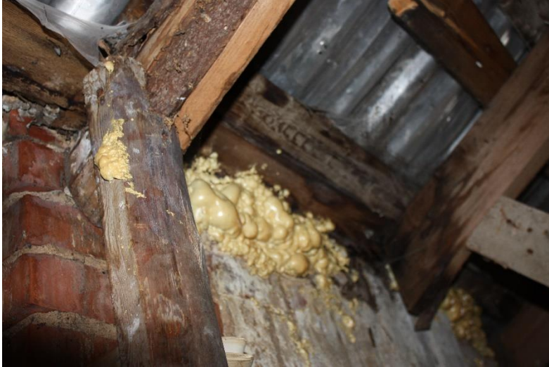
Kuva 64. Vesikatto vuotanut savupiipun juuresta.
