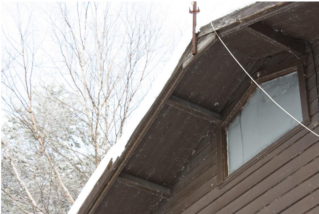
Kuva 36. Haljennut ikkunalasi sekä lahonnut räystäslauta.
