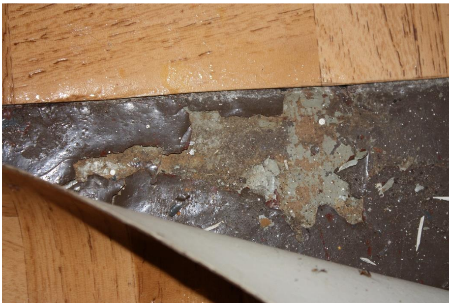
Kuva 52. WC:n muovimaton alle päässyt saumoista vettä.
