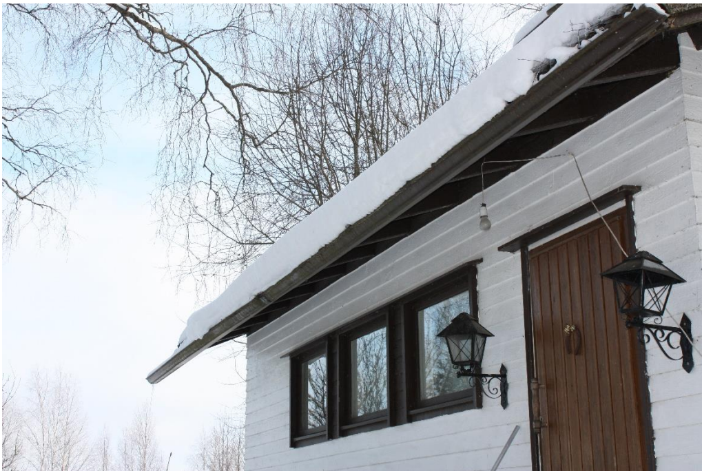
Kuva 30. Vesikourusta vesi putoaa reilun metrin päähän sokkelista.
