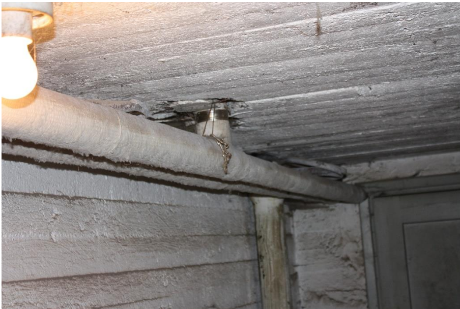
Kuva 62. Mahdollisesti asbestia sisältävät putken eristeet kellarissa.
