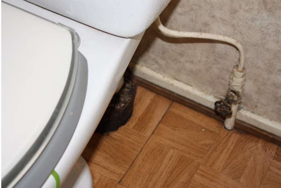
Kuva 51. WC-pöntön vanhat huonot tiivisteet. Läpivientjä ei ole tiivistetty.
