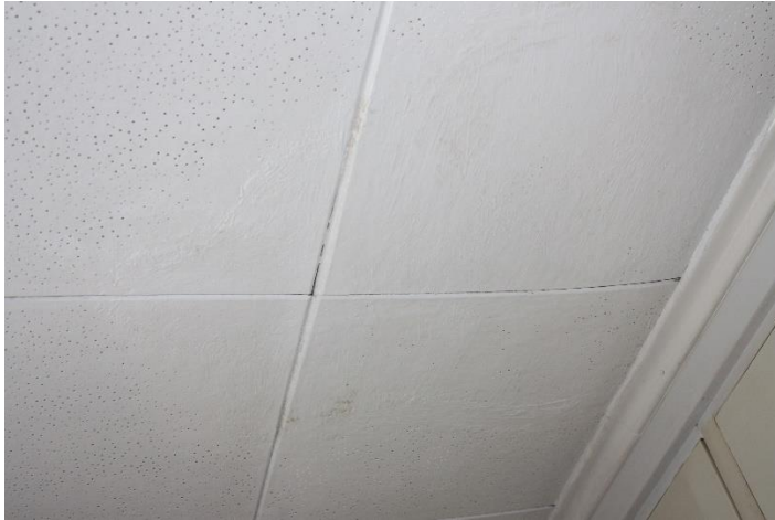
Kuva 53. Keittiön katossa näkyy vanha kosteusvaurio.
