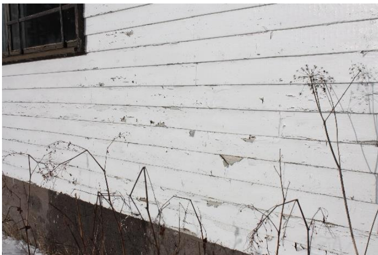
Kuva 35. Lohkeilevaa maalipintaa etelän puoleisella seinällä.
