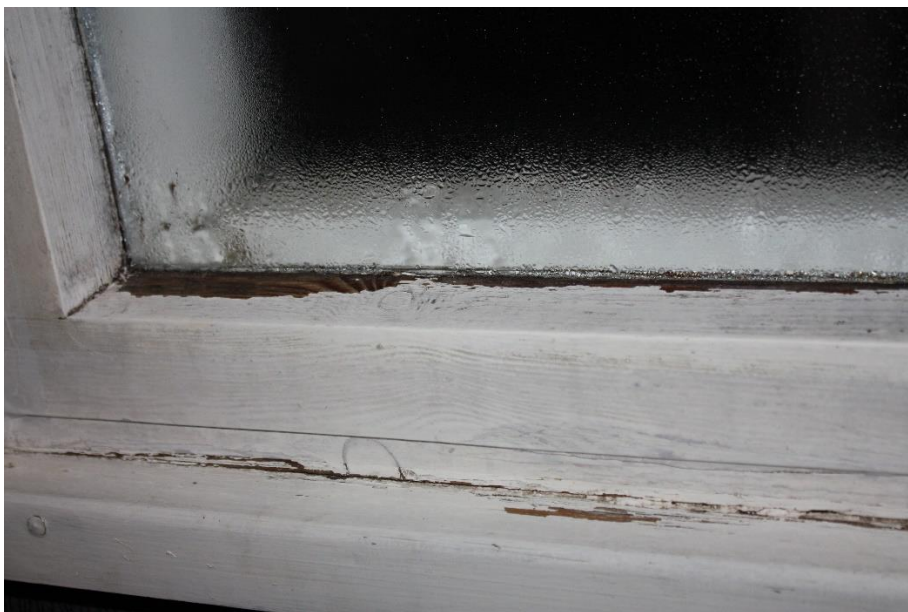
Kuva 57. Ikkunalasiin tiivistyneen kosteuden aiheuttamaa maalin irtoamista.
