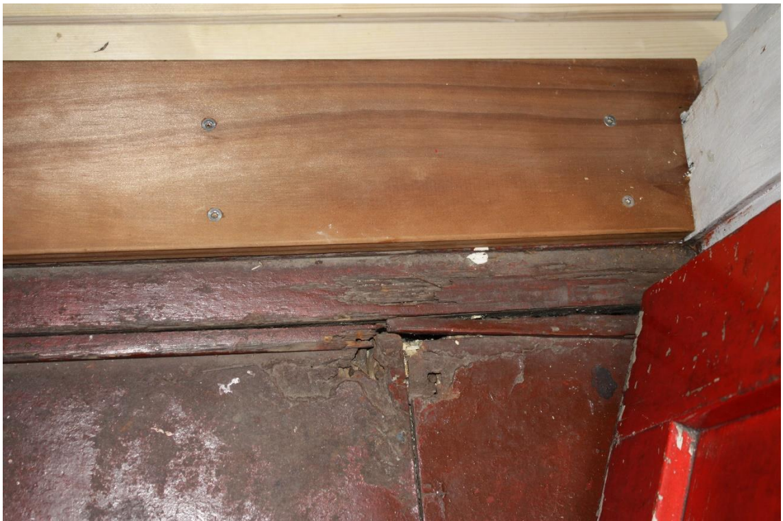
Kuva 47. Saunan uuden kynnyksen alta näkyy vanhaa lahonnutta kynnystä.
