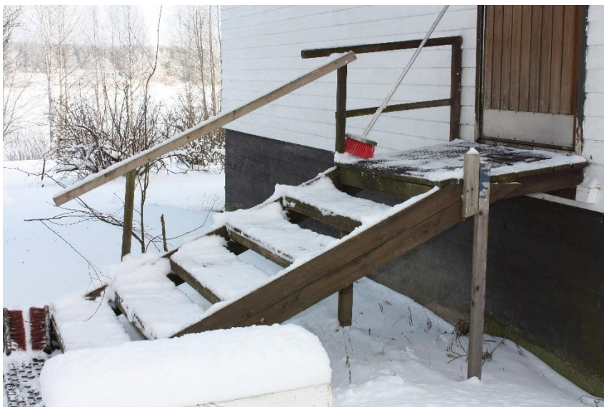
Kuva 73. Rakennuksen portaat on vaarallisen heikossa kunnossa.
