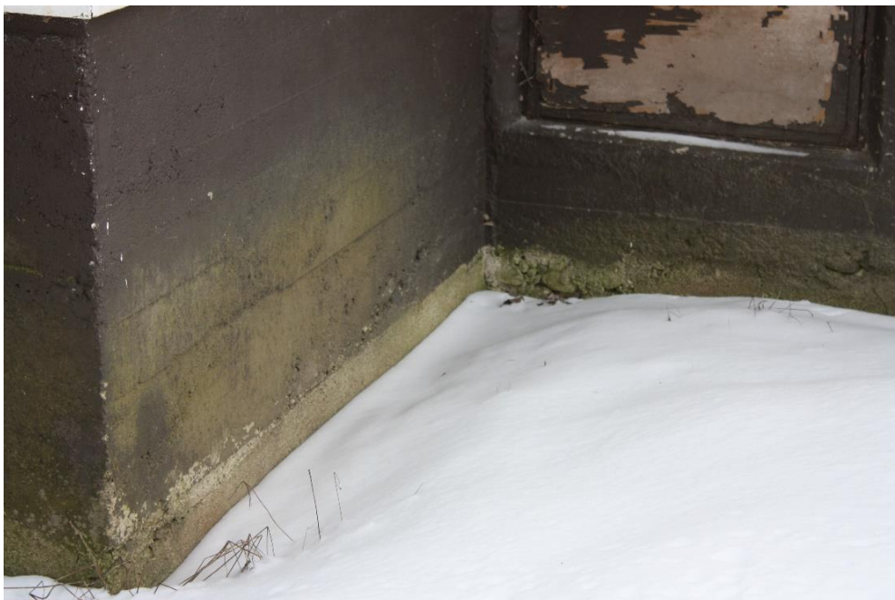
Kuva 32. Pientä rapautumaa nähtävissä perusmuurissa.
