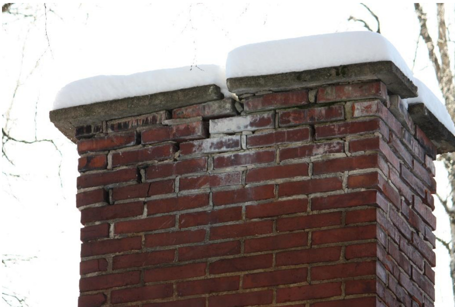
Kuva 71. Muuratun savuhormin yläosa on rapautunut pahasti.
