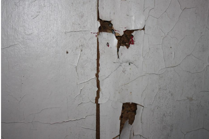
Kuva 37. Lohkeileva maalipinta tuulikaapin seinässä sekä homepilkkuja kuitulevyssä.
