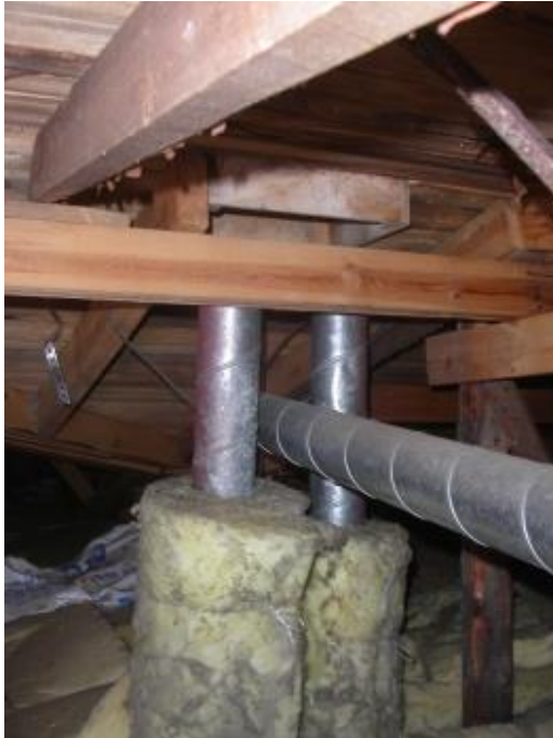
Kuva 9. Osittain eristämättömät putket myös päättyvät yläpohjaan.(7)
