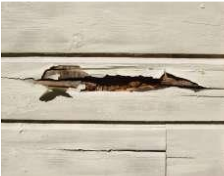
Kuva 7. Tiivis maalipinta on aiheuttanut lahovaurion ulkoseinään.(12)
