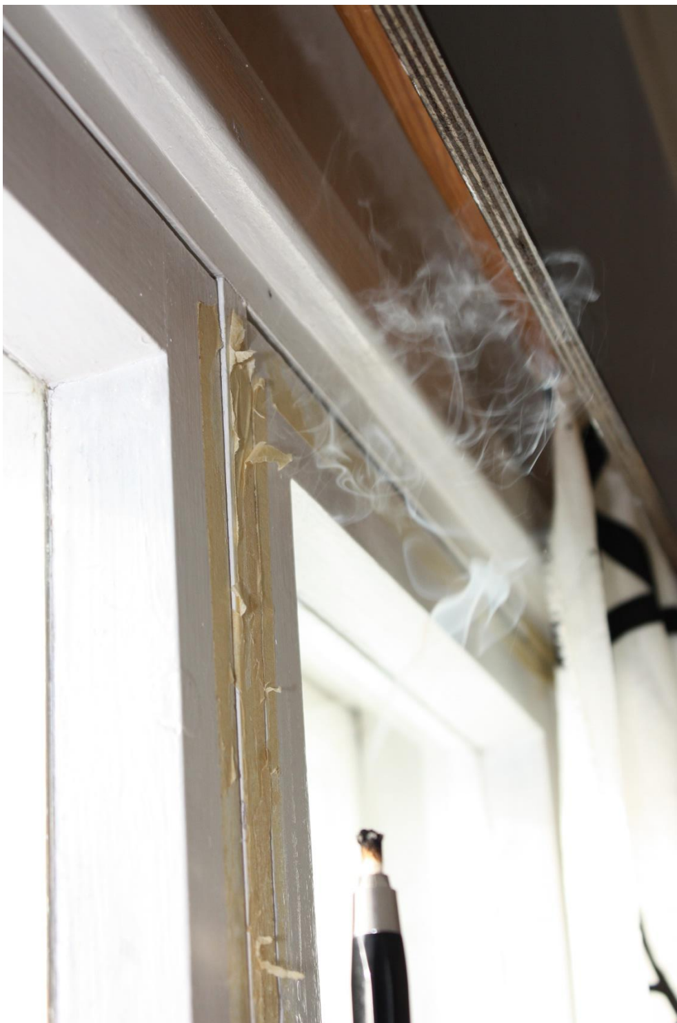
Kuva 1. Olohuoneen ikkunan saumoista oli pientä ilmavirtausta havaittavissa sisäänpäin. Myös muissa ikkunoissa huomattiin vastaavaa. Koska rakennuksesta puuttuu korvausilma-venttiilit, tulee korvausilma kaikista epätiiviyistä saumoista.
