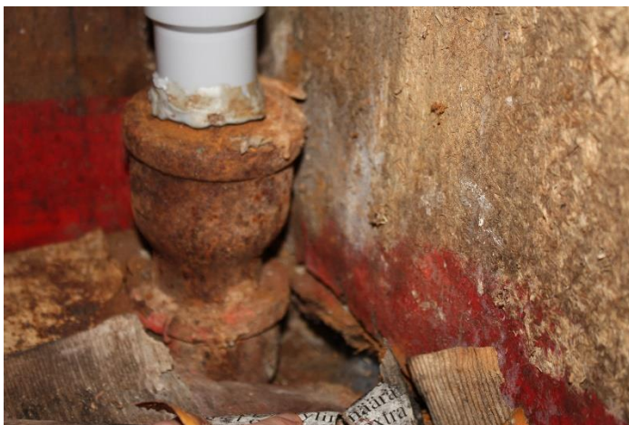
Kuva 54. Keittiön lavuaarin viemäri vuotanut kaapin pohjalle.
