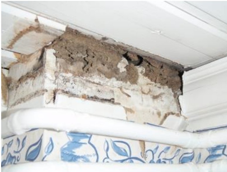
Kuva 10. Vuotava piipun läpivienti aiheuttaa kosteusvaurion sisätiloihin.(7)
