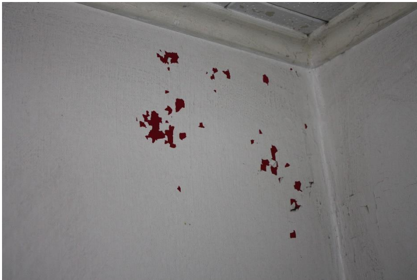
Kuva 38. Irtoavaa maalikalvoa tuulikaapissa.
