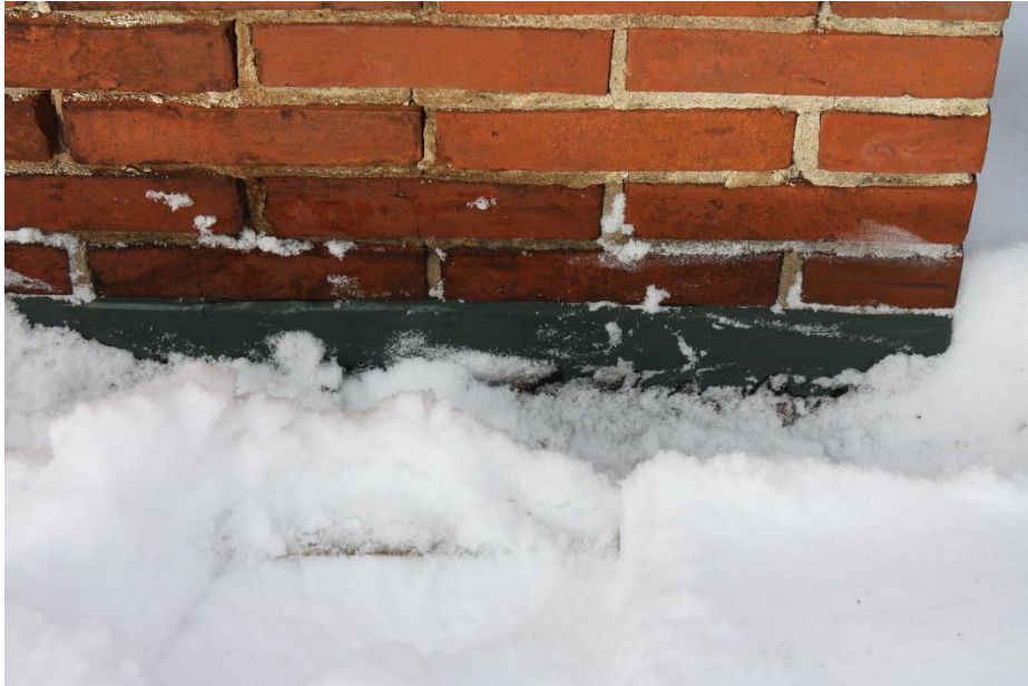
Kuva 70. Muuratun hormin juuri paikattu tilapäisesti bitumiteipillä.
