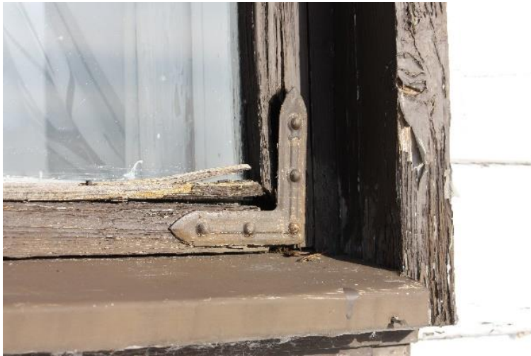
Kuva 66. Puutteelliset ikkunapellytykset ja ikkunapokien vaurio.
