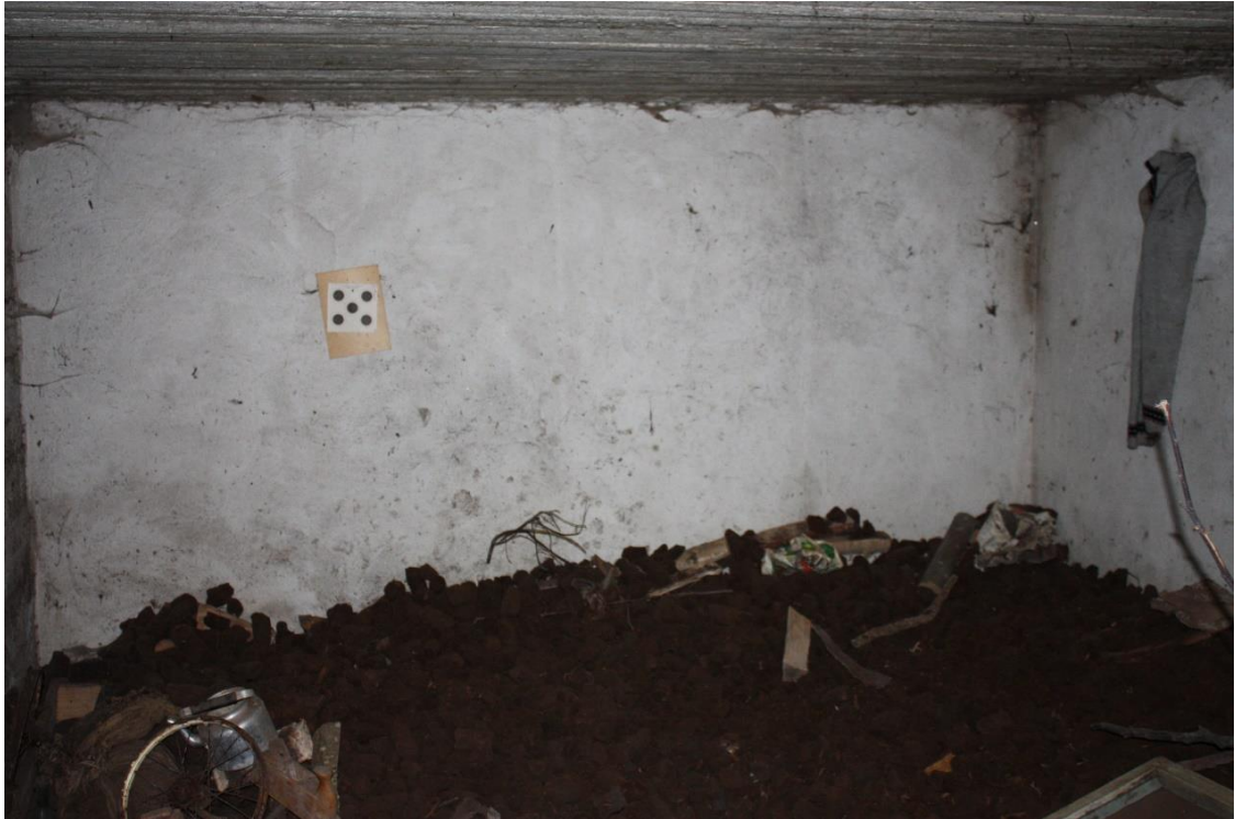
Kuva 58. Turvevarasto kellarissa. Ilmanvaihtoaukko on tukittu kankaalla.
