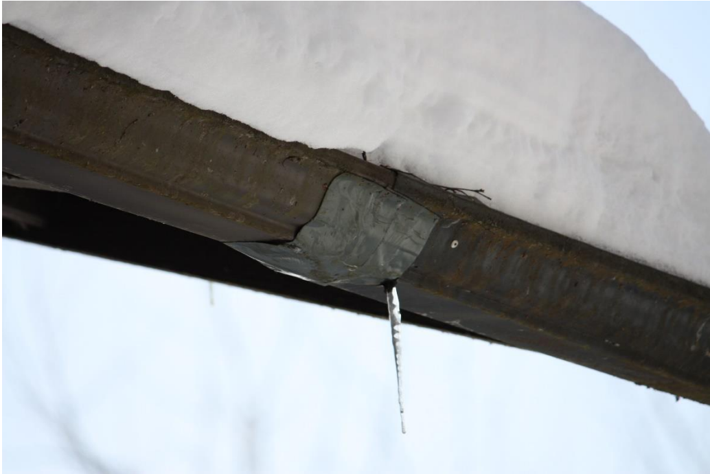
Kuva 29. Vesikourun paikkaus vuotanut.
