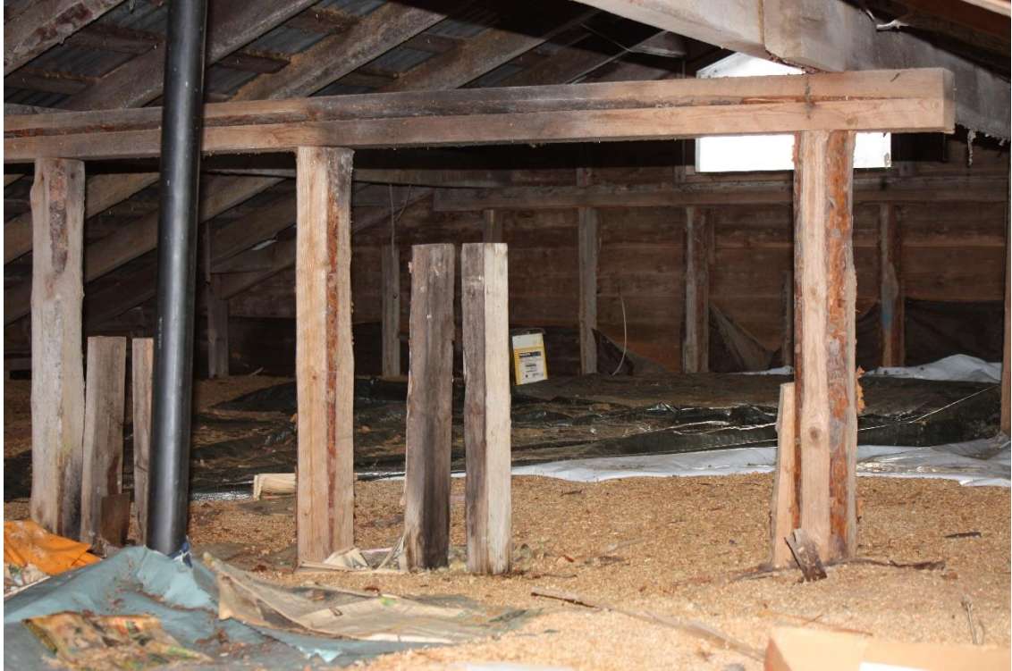
Kuva 63. Yläpohjan eristeiden päällä näkyy muovipressuja.
