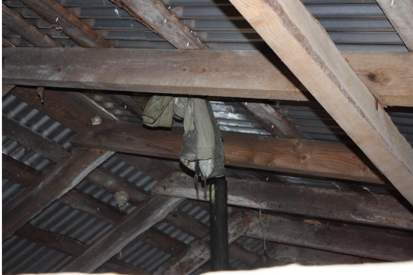
Kuva 68. WC:n poistoilmaputki päättyy yläpohjaan ja läpivientiaukko tukittu kankaalla.
