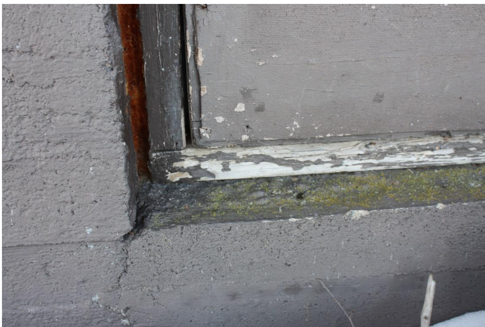
Kuva 33. Kellarin ikkunoiden puuosat joutuvat kovaan vesirasitukseen.
