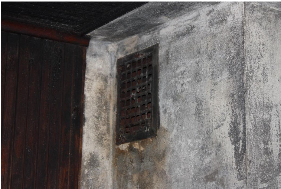
Kuva 44. Saunan poistoilmakanava muuratussa hormissa.
