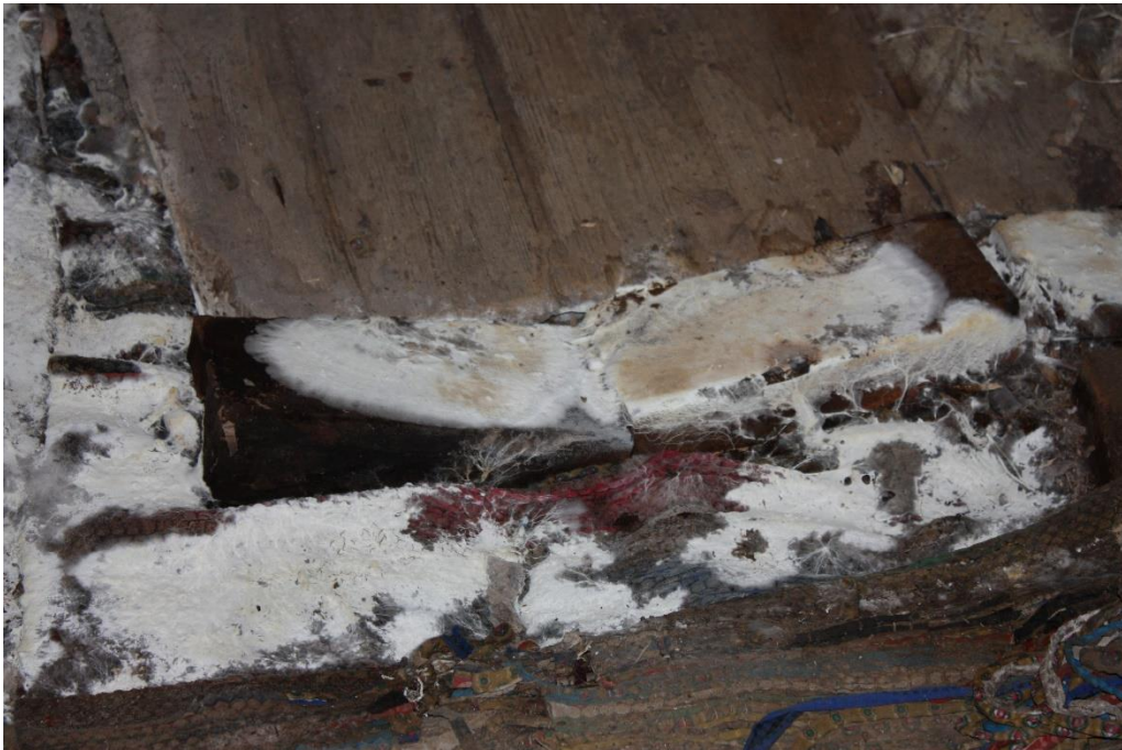
Kuva 60. Kellarin puuvaraston lattia on kauttaaltaan homeessa.
