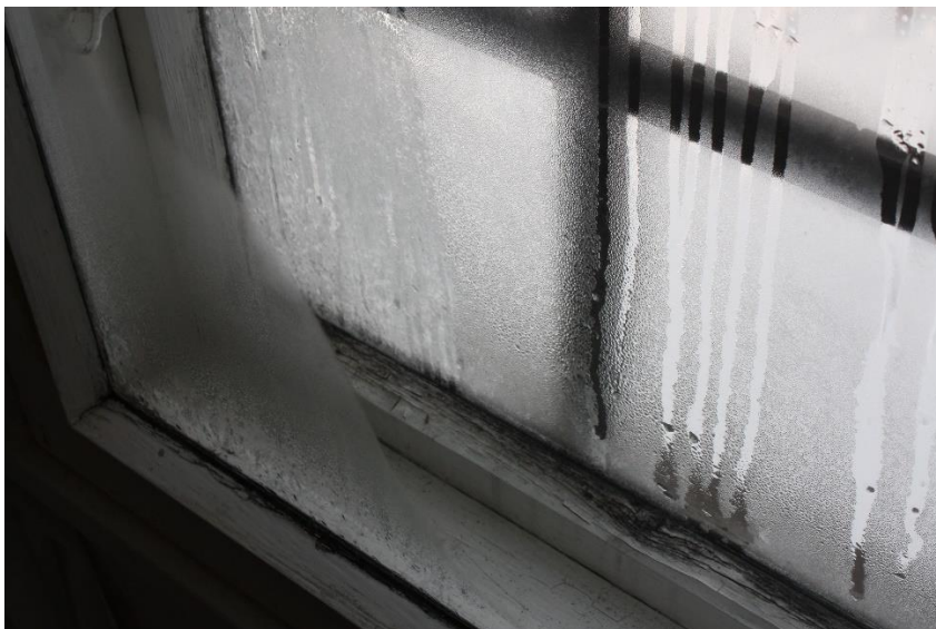
Kuva 67. Molempien lasien sisäpinnat huurustuu ja valuva vesi aiheuttaa vaurioita puusiin.
