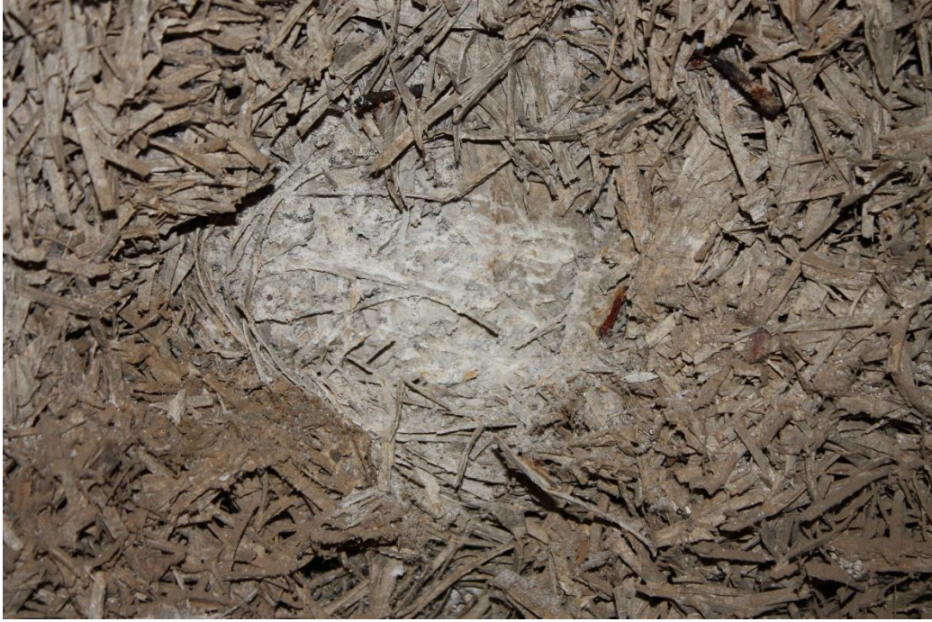
Kuva 59. Tojax-levyn ja perusmuurin välissä ei näkynyt vedeneristettä
