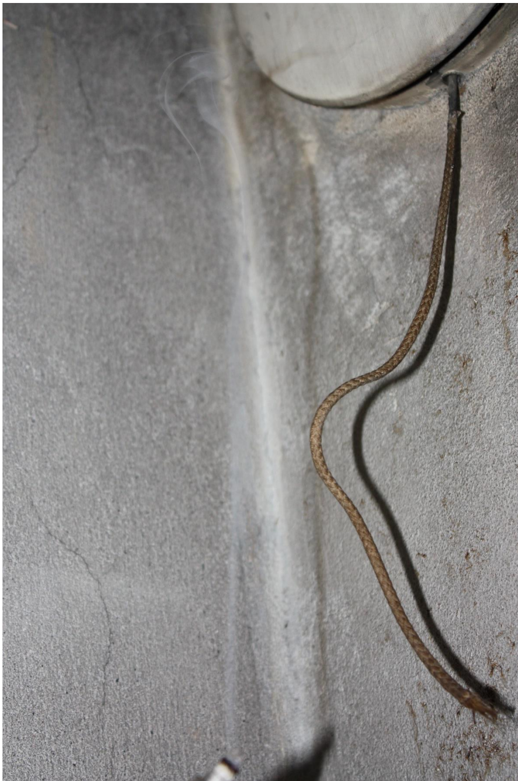
Kuva 2. Pukuhuoneen poistoilmakanava oli merkisavukokeiden perusteella ainut poistoilmakanava joka toimi.
