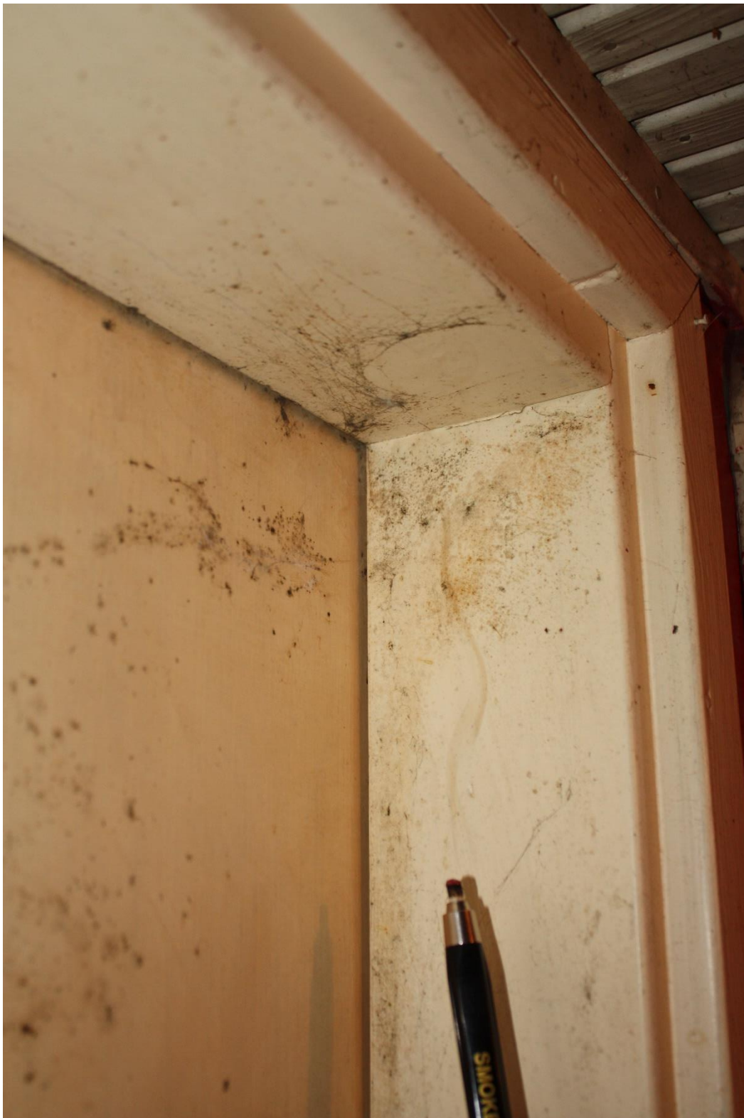
Kuva 4. Kellarin puolelta savu ei ainakaan voimakkaasti kulkeutunut oven saumakohtiin.
