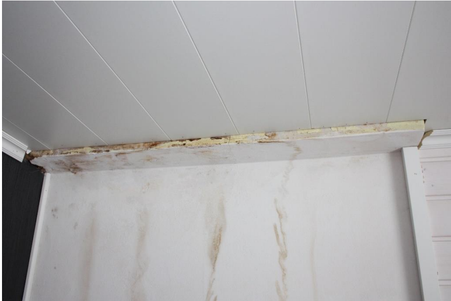
Kuva 56. Vesikatto vuotanut sisään asti muuratun hormin juuresta.
