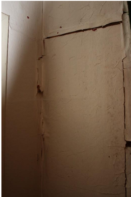
Kuva 45. Kosteuden tiivistymisen vaikutuksia tuulikaapissa.
