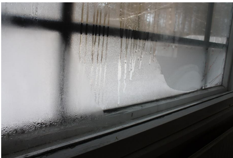
Kuva 46. Saunomisen aiheuttaman kosteuden tiivistymistä keittiön ikkunaan.
