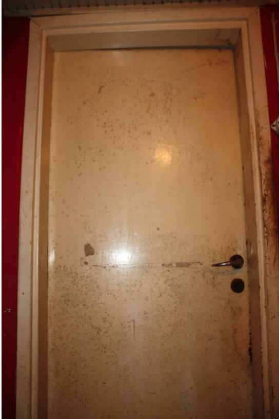
Kuva 61. Homepilkkuja kellarin ovesa kellarin puolella.
