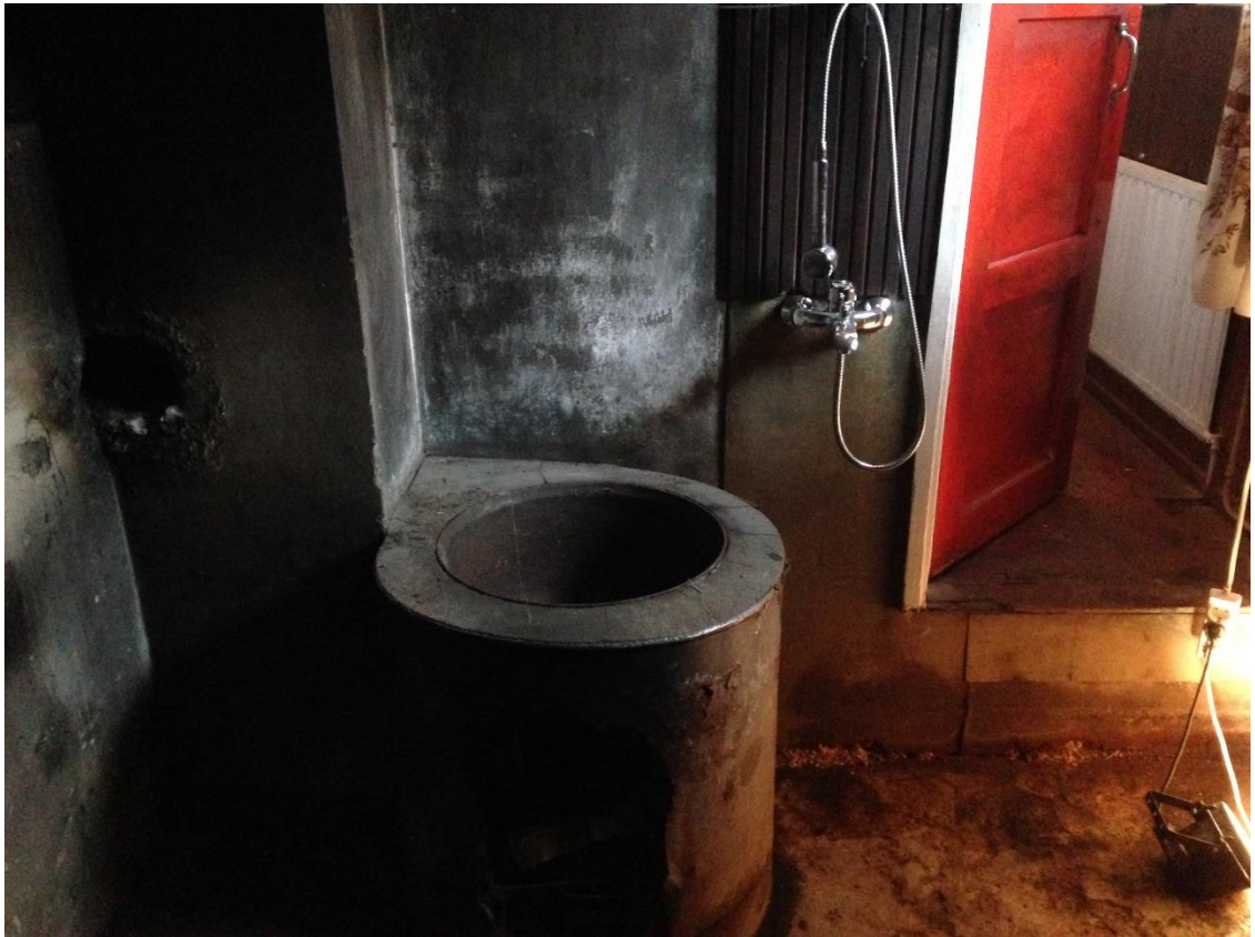
Kuva 48. Peseytymispaikka ennen korjauksia.
