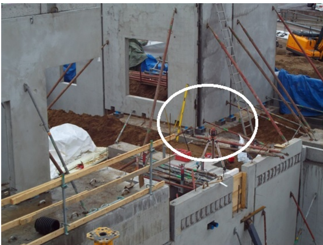
Kuva 8. Elementtisuunnitteluvirhe, jossa elementit asennettiin korjausdetaljin mukaisesti.
