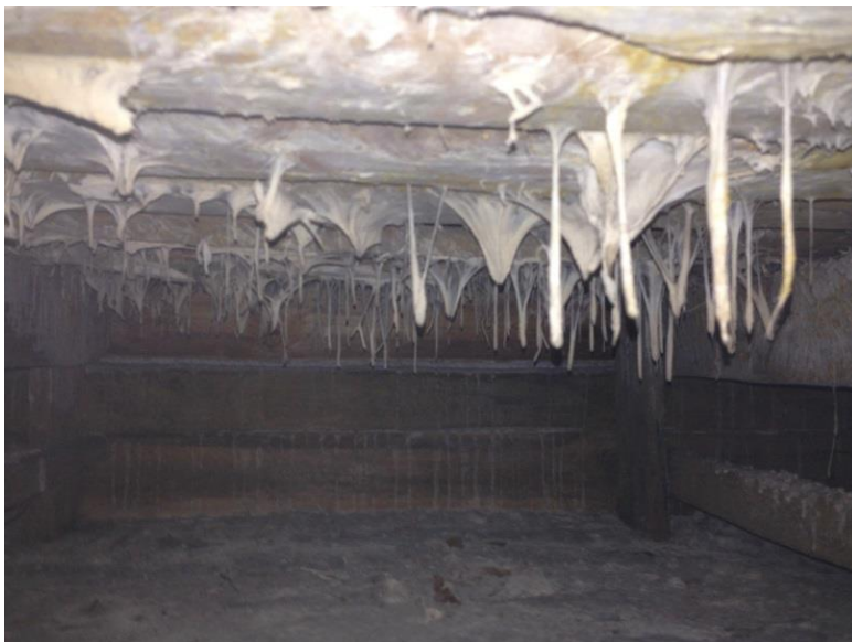
Kuva 18. Kaksoislaattapalkiston ylälaatan laudoituksen pinnassa rihmakasvustoa lähde/31/.
