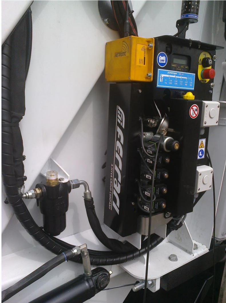
KUVA 28. Painesuodattimen ja ohjausventtiileiden letkutusia Ferrarista
