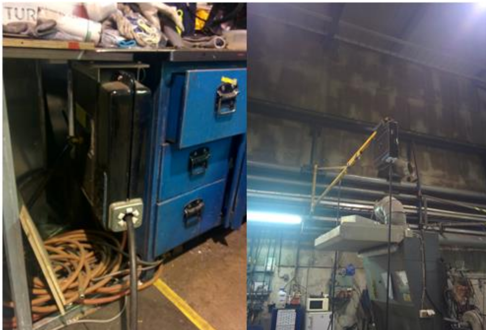
Kuva 23. Ilmaletkukelat asennettuna pöydän alle ja puomille työpisteen yläpuolelle.
