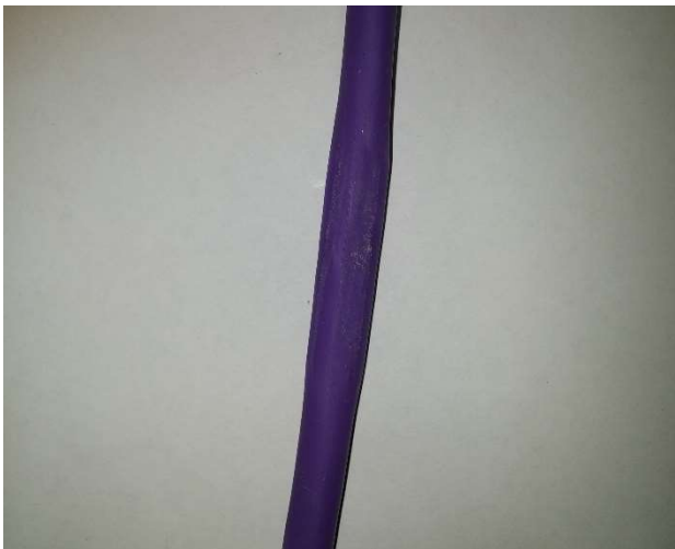
Kuva 15. A-tikkaiden jättämät jäljet kaapelissa.
