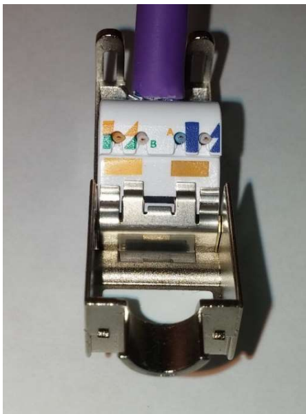
Kuva 17. Suojattu liitin kytkettynä liitinhahloon väärin päin.
