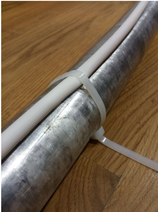
Kuva 6. Cat 6A -kaapeli kaapelisiteellä kiinnitettynä.
