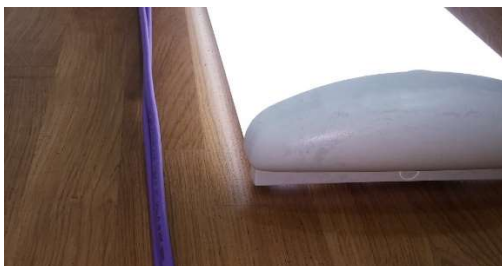
Kuva 12. Cat 6, STP-kaapeli loistevalaisimen vieressä.
