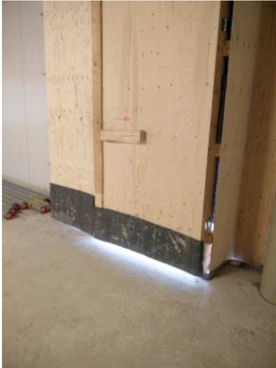
Kuva 2. Business Park Rantatien laajennus. Haalausaukkojen ovien alta saatiin korvausilmaa, mutta tuuli saattaa tuoda niistä lunta sekä satevettä sisään.
