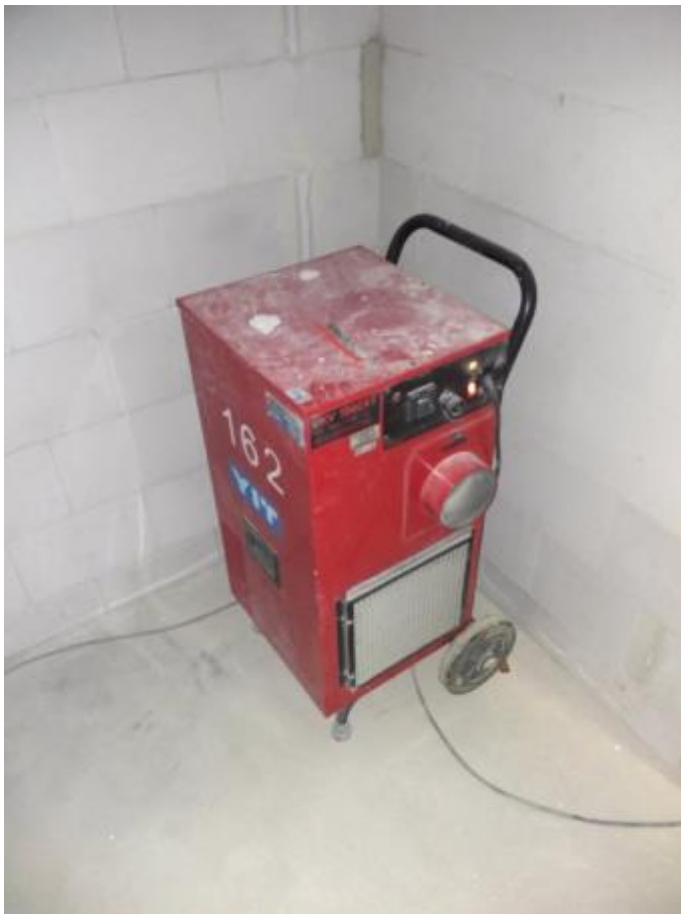
Kuva 11. Business Park. Absorptiokuivan wc-tilassa.
