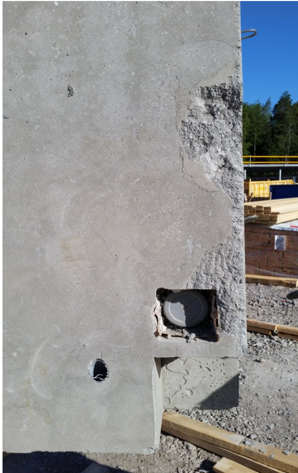
Kuva 6. Varastoinnissa kolhittu Luja-hormielementti
