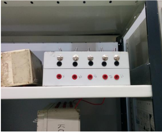
KUVA 23. Ylimääräiset läpiviennit on korvattu metallisilla tulpilla
