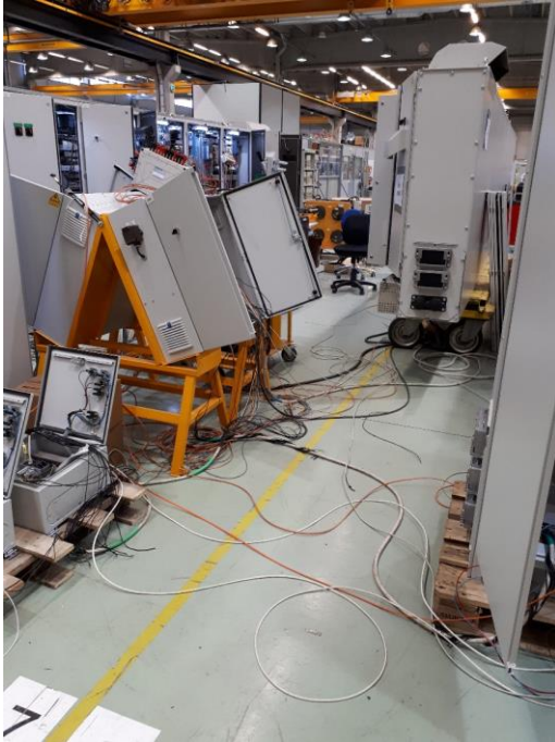
KUVA 29. Kompastumisriksi kasvaa, jos testausjohtimet asetellaan huolimattomasti
