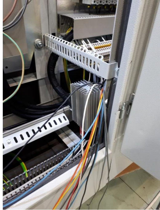
KUVA 30. Johdot voivat hankautua teräviin reunoihin sähkökaapissa
