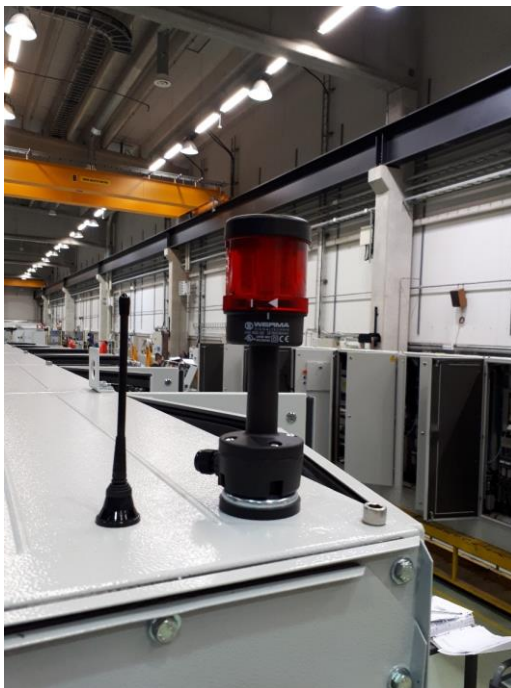
KUVA 15. Varoitusvalotorni sähkökaapin päällä
