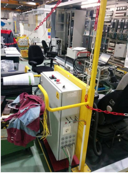
KUVA 8. Ohjaamon sähkökeskus liian lähellä testausalueen rajaa
