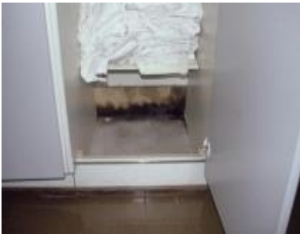
Kuvio 3. Pesutilan seinän kosteusvaurio on tuhonnut kaapiston alaosan. Korjaustapa, kalusteiden ja seinän purku ja korjaus.
