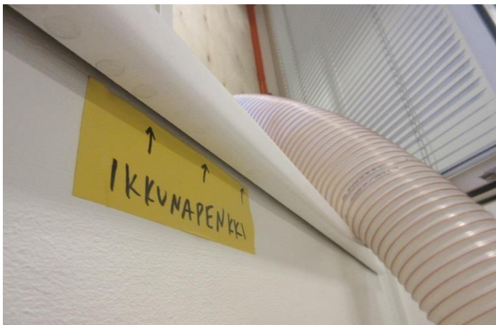
Kuva 3. Molemmilta ikkunapenkeiltä runsasta vuotoa
