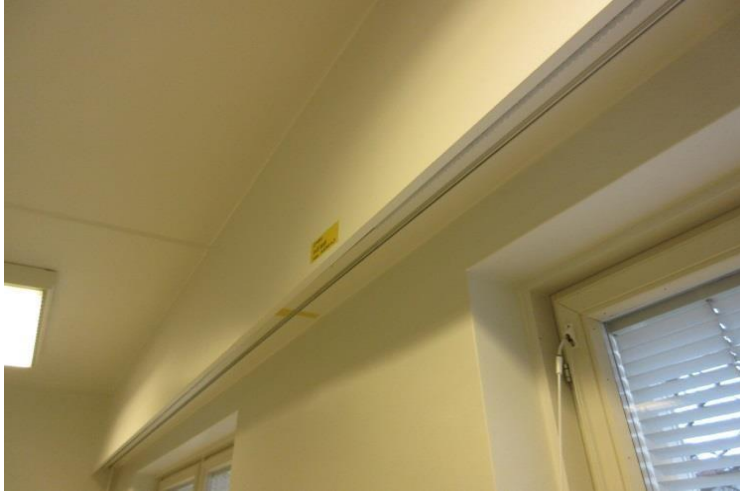
Kuva 5. Kappalaudan koteloilta runsasta vuotoa koko tilassa
