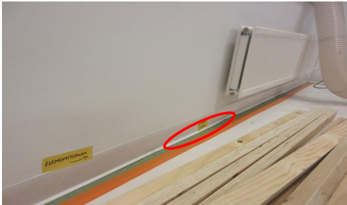
Kuva 2. Keskellä huoneen ulkoseinää elementtisaumakohta vuotaa lattiarajan tuntumasta. Lisäksi kuvaan ympyröitynä ulkoseinä-lattialiittymä, josta runsasta vuotoa
