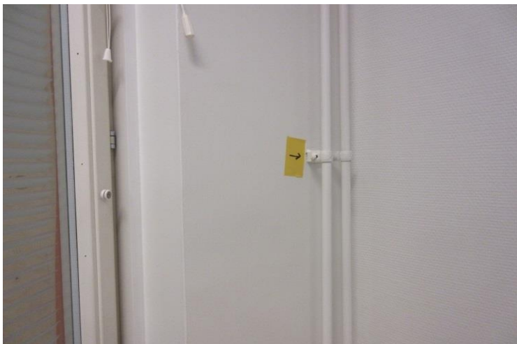
Kuva 6. Patteriputken kiinnikkeeltä lievää vuotoa
