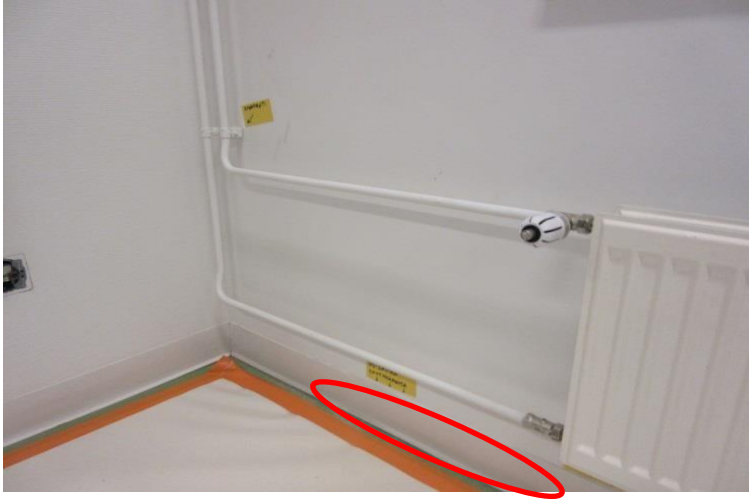
Kuva 7. Patteriputken kiinnikkeiltä lievää vuotoa (myös ylempää kuvan ulkopuolelta). Lisäksi kuvaan ympyröitynä ulkoseinä-lattialiittymän alue, josta runsasta vuotoa
