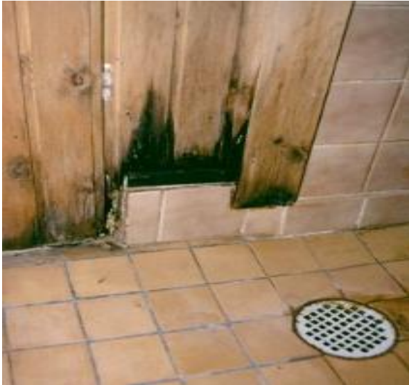
Kuvio 2. Kosteusvaurio kylpyhuoneen puuosissa. Korjaustapa, kohteen purku ja pesuhuoneen uudistaminen.
