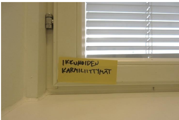
Kuva 4. Ikkunoiden karmiliittymiltä kauttaaltaan lievää vuotoa
