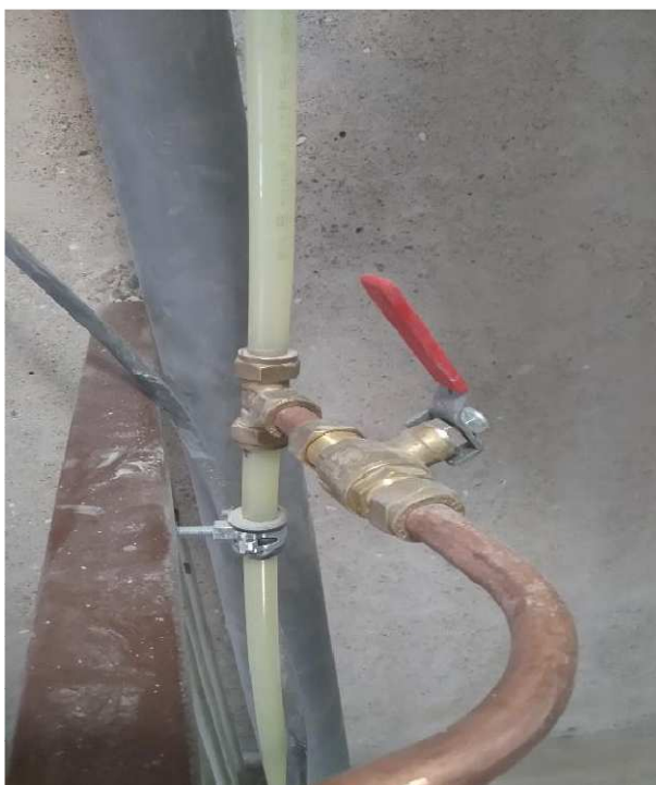
Kuva 11. Työnaikainen vesiliittymä. Jokaisessa kerroksessa on oma sulkuhana.
