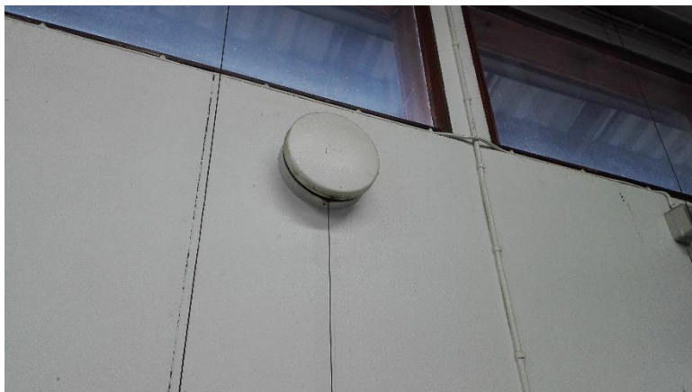
Kuva 23. Seinällä oleva likainen korvausilmaventtiili
