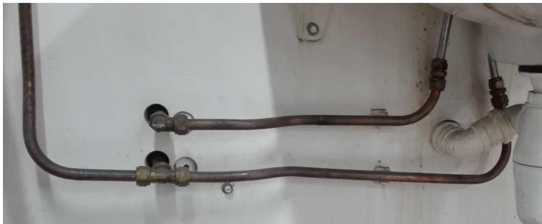
Kuva 20. Vesijohdot ovat pääsääntöisesti tyydyttävässä kunnossa
