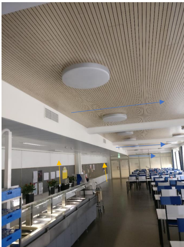
Kuva 29. Tuloilmasäleiköt Myllypuron ala-asteen ruokalassa. Poistoilmasäleiköt kotelon alapinnassa. Tuloilma merkattu sinisillä nuolilla ja poistoilma keltaisilla
