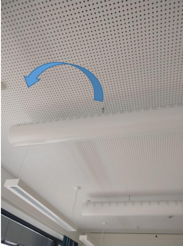
Kuva 27. Suutinkanavia luokkatilassa Myllypuron ala-asteella. Suutinkanava on yleinen tarpeenmukaisen ilmanvaihdon päätelaite. Ilmavirran suuntaa kuvaa sininen nuoli.
