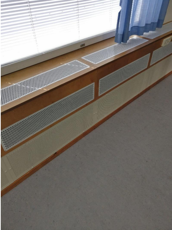
Kuva 12. Tuloilmaritilä (alla) ja lämmityspattereiden kotelointi
