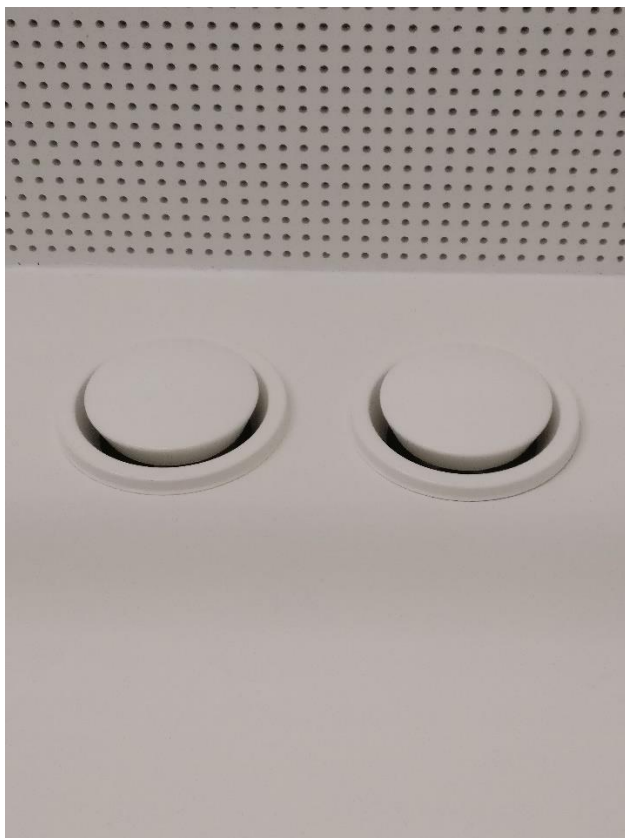
Kuva 28. Poistoilmavettiilit luokkatilassa Myllypuron ala-asteella
