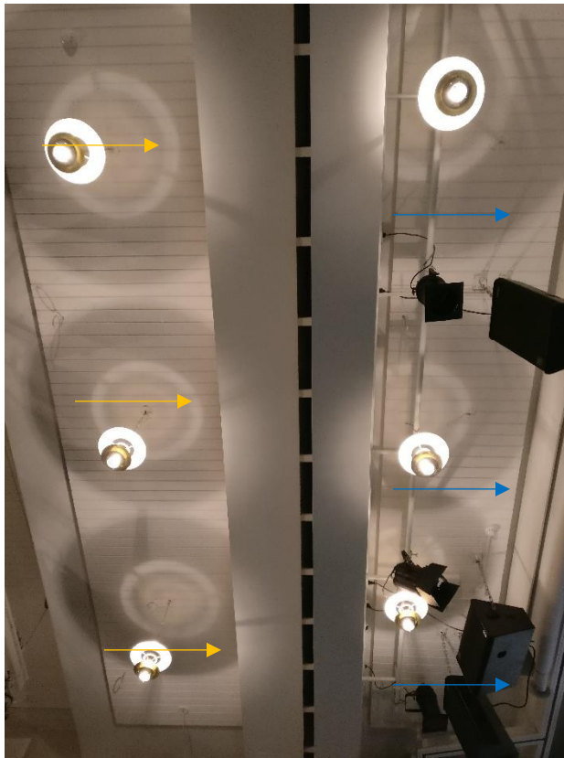
Kuva 20. Tulo- ja poistoilmasuuttimien kotelointi, poistoilman suuntaa kuvaa keltaiset nuolet ja tuloilmaa siniset, esiintymislava kuvan ulkopuolella oikealla
