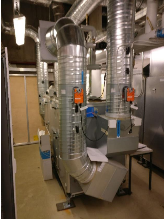
Kuva 16. Pienempi ilmanvaihtokone Sandelsin koululla(201TK2/PK2), oikealla puolella näkyy osa pääilmanvaihtokoneesta (201TK1/PK1)
