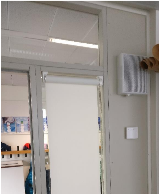
Kuva 26. Esimerkki lämpötila- ja hiilidioksidianturista Myllypuron ala-asteella. Keskusradion alapuolella, luokan oven viereen asennettuna
