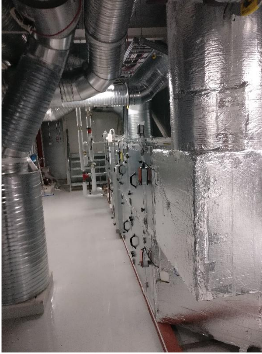
Kuva 25. Ilmanvaihtokone Myllypuron ala-asteella
