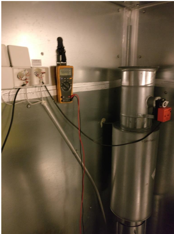
Kuva 14. Luokkatilaan lähtevä tuloilman hajotusputki ja rikkoontunut peltimoottori
