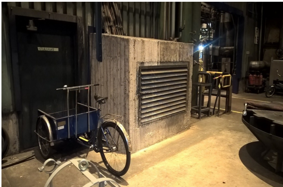
Kuva 10. Kaapelitunnelin tuuletusaukon ritilä.
