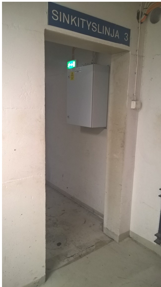
Kuva 9. Sinkki 3-henkilötunnelin oviaukosta puuttuu palo-ovi
