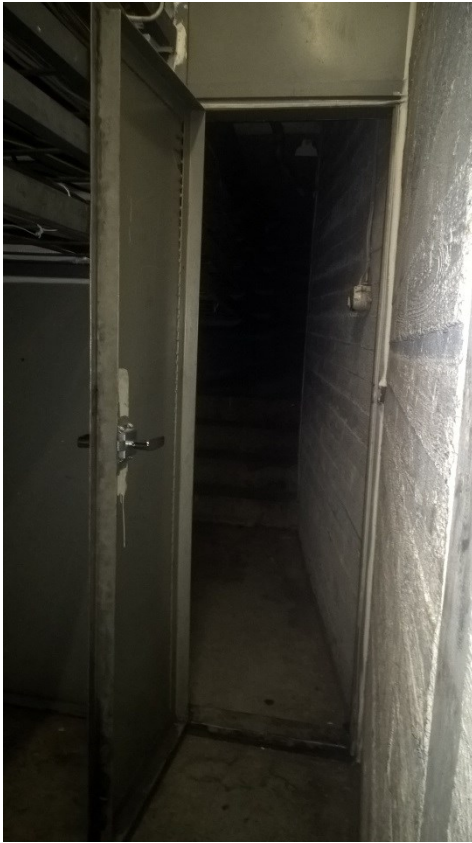
Kuva 5. Sinkki 1-kaapelikellari ja kaapelitunnelin välinen peltiovi
