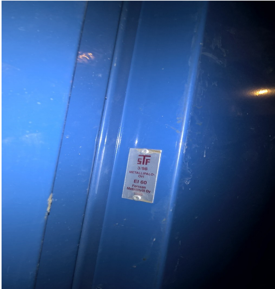
Kuva 7. Sähkötila SK8-laajennuksen asianmukainen palo-ovi
