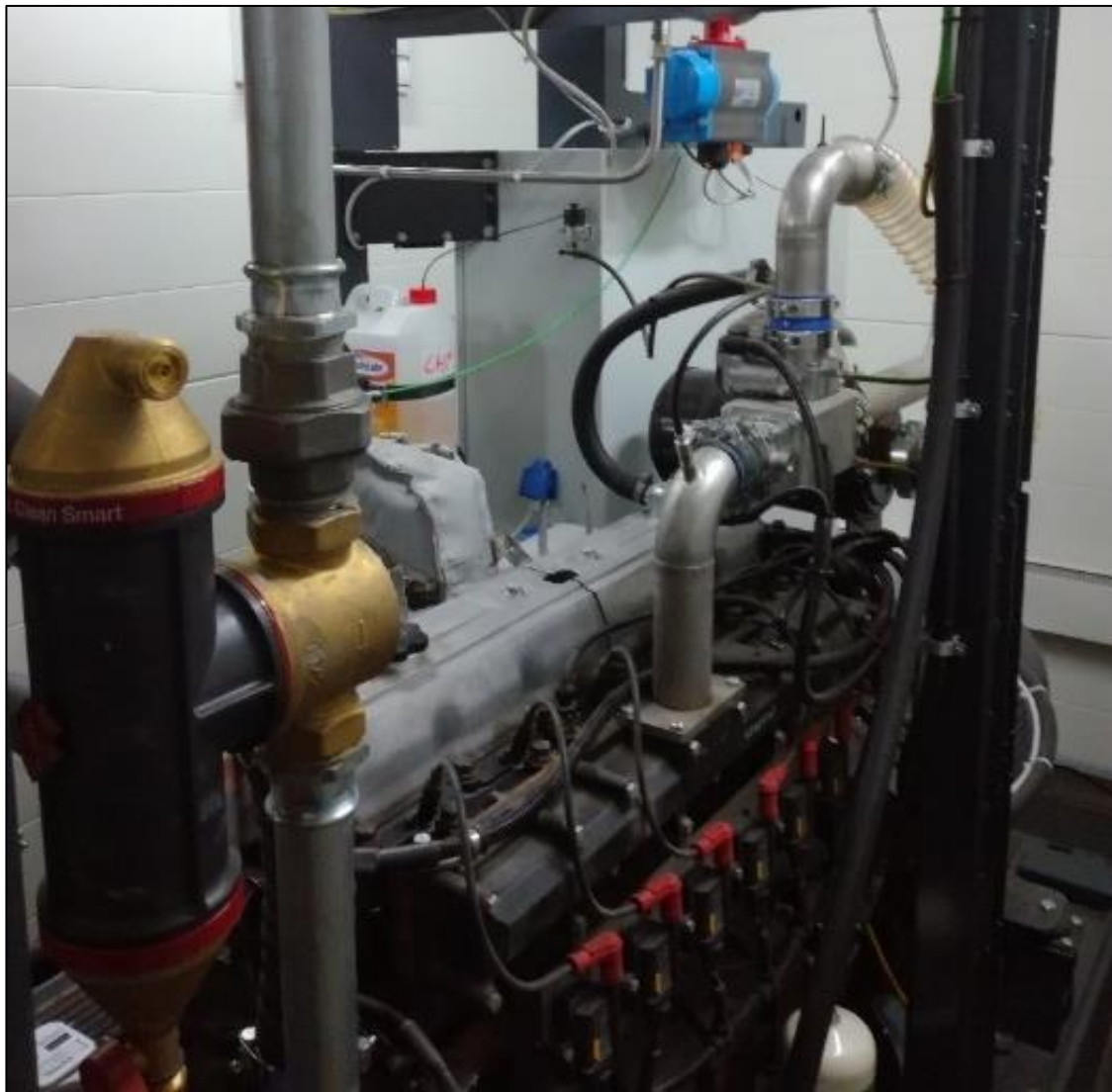
Kuva 7. Volterin 140 kW:n pien-CHP-voimalan 40 kW e :n kaasumoottori Karelia-amk:n Sirkkalan Energiapuistossa (Kuva: Toni Kortelainen 2017).
