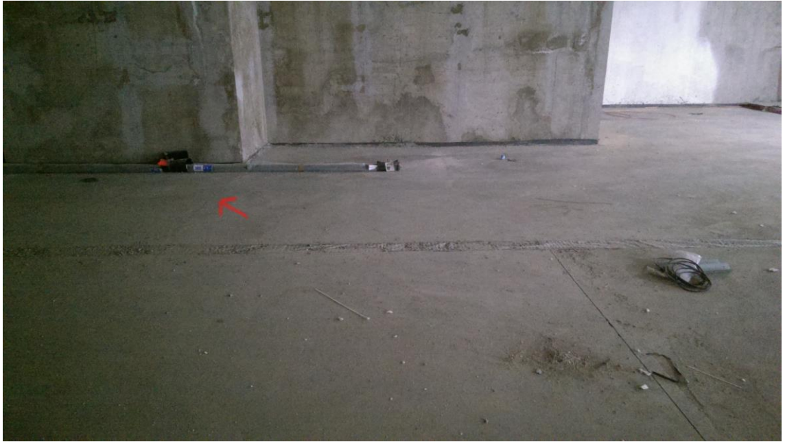
KUVA 15. Liikuntasaumarauta asennettuna hissikuilun nurkkaan, eikä samalle linjalle aikaisemman liikuntasaumaraudan kanssa (kuten piirustuksiin oli merkitty).
