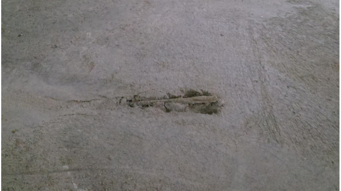
KUVA 29. Betonin pintaan noussut teräs.
