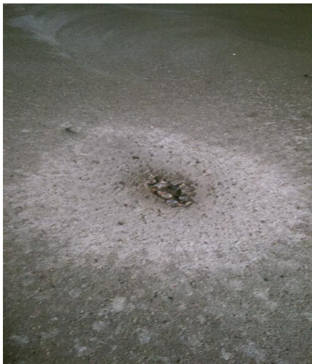
KUVA 28. Tippuvan veden aiheuttama kolo lattiassa.
