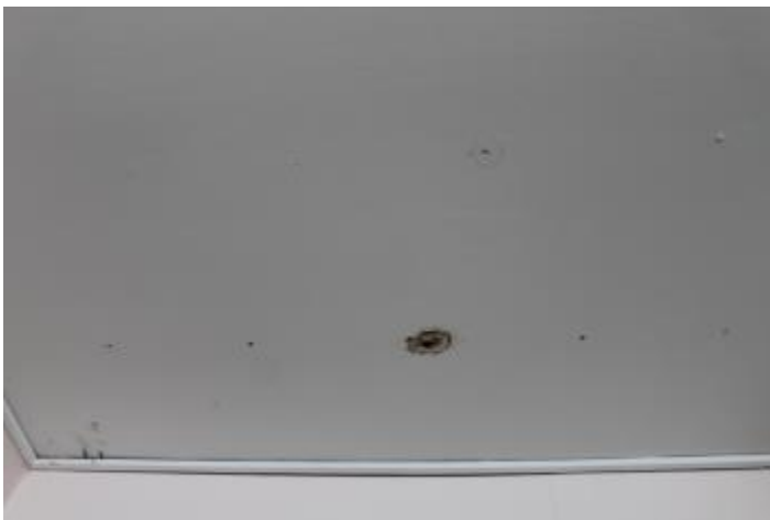
Kuva 17. Asuntolan vaurioitunut alakatto.
