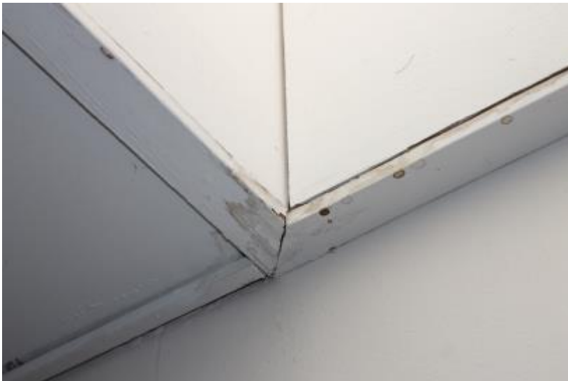
Kuva 13. Kattoikkunan listassa kosteuden aiheuttamia jälkiä.
