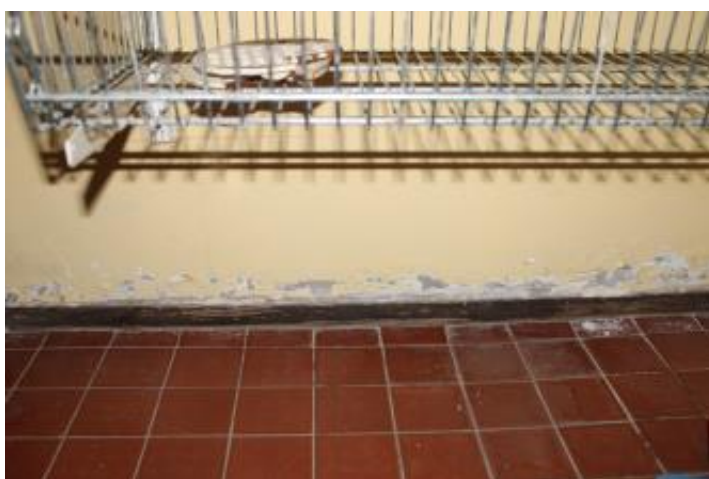
Kuva 8. Betoniseinän hilseillyt maalipinta.
