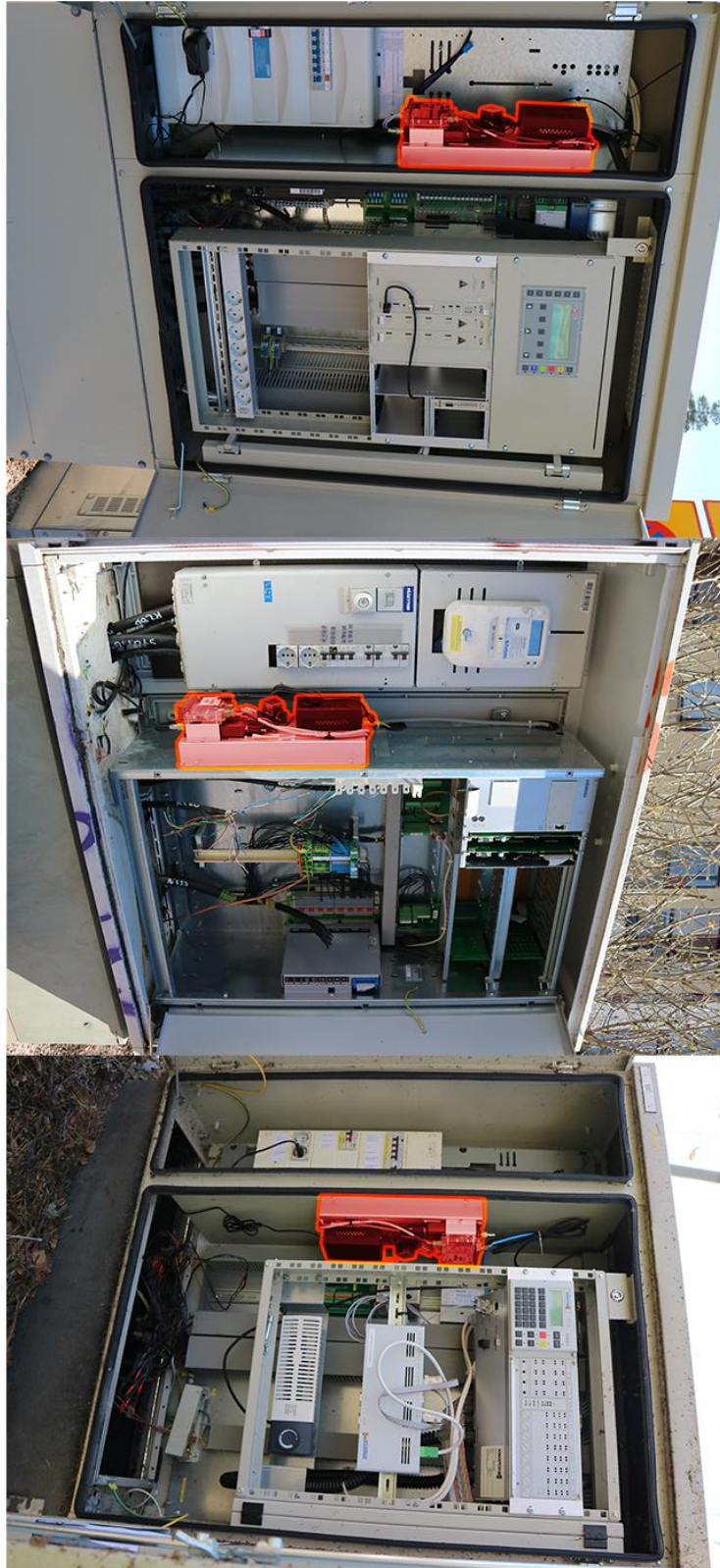
Liikennevalojen ohjaukkojeita sekä etuuslaitteen asennussijainti niiden sisällä (vasemmalta oikealle): Dynniq EC-2, Siemens C800, Swarco ITC-2
