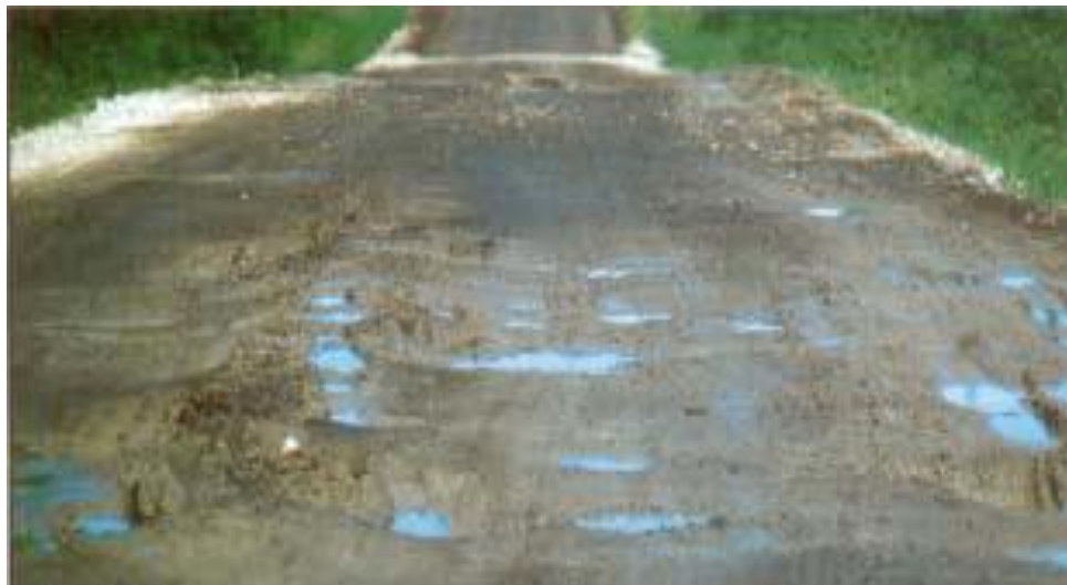
Kuvio 10: Runkokelirikon esiintyminen vaurioluokassa 2 (Sorateiden runkokelirikon inventointiohje 1996, 11)
