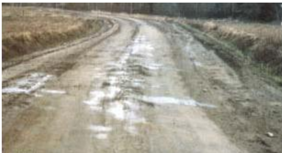
Kuvio 11: Runkokelirikon esiintyminen vaurioluokassa 3 (Sorateiden runkokelirikon inventointiohje 1996, 12)
