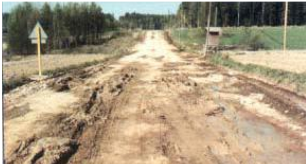
Kuvio 9: Runkokelirikon esiintyminen vaurioluokassa 1 (Sorateiden runkokelirikon inventointiohje 1996, 10)
