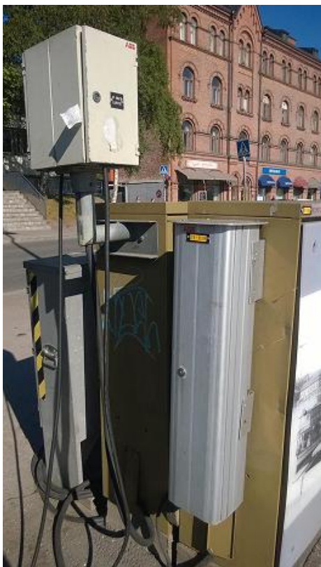
Kuva 17. Jätepuristimen sähkökeskus (kuvannut Janika Kunnari. Kuvan käyttöön on saatu lupa).
