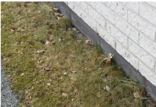
Kuva 25. Kalkkihärmettä sokkelin pinnassa.
