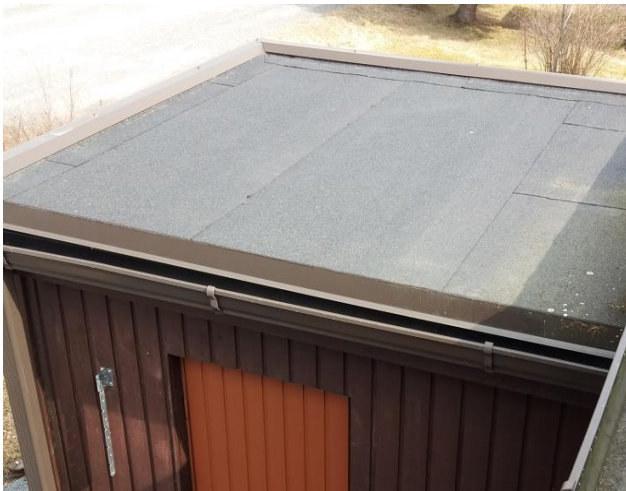
Kuva 19. Liian vähäinen kallistus voi aiheuttaa lammikoitumista katolle.
