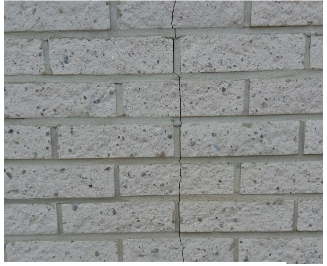
Kuva 28. Päätyseinän pystyhalkeama ulottuu sokkelista kerrosvesipeltiin saakka.
