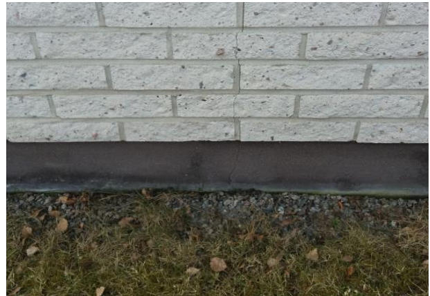
Kuva 24. Sokkelin alareunan sammaloitumista.
