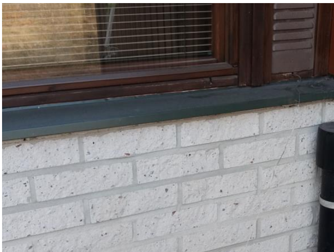
Kuva 39. Kuvassa näkyy ikkunapellin liian vähäinen kallistus.
