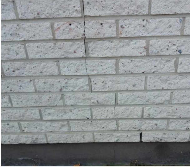
Kuva 27. Halkeama päätyseinässä ikkunan alapuolella.
