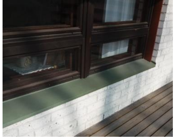
Kuva 42. Kuvassa terassinpuoleinen iso ikkuna. Ikkunoiden ulko- ja sisäpinnat ovat suhteellisen hyvässä kunnossa.
