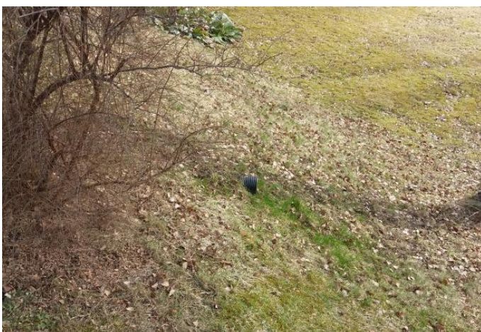
Kuva 1. Jyrkästi viettävä rinne ja naapuritalon sadevesien purkupuutki.
