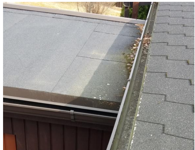
Kuva 20. Kattojen päätyreunaan kertyy helposti lehtiä ja muita epäpuhtauksia.
