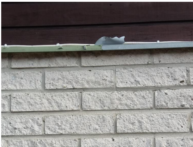
Kuva 31. Kerrosvesipelin maalipinta hilseilnyt. Hilseilyä esiintyy eniten rakennuksen
