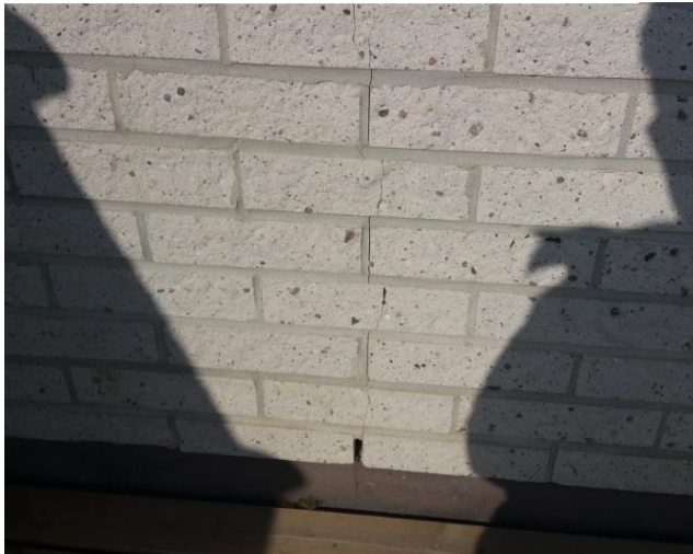
Kuva 29. Halkeamia löytyy myös talon takapihalta.
