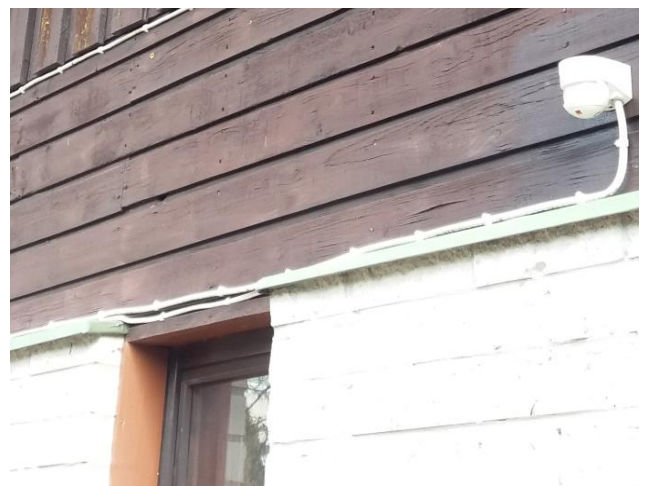
Kuva 32. Suojaamattomia sähköjohtoja. Kaikki talon ulkopuoliset johdot ovat suojaamatta.
