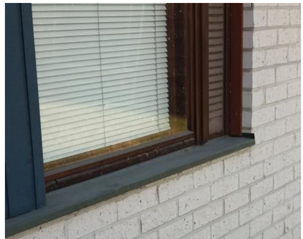
Kuva 40. Pääasiassa etupihan puoleisissa ikkunapelleissa on ongelmia kallistusten ja tiivistysten suhteen.
