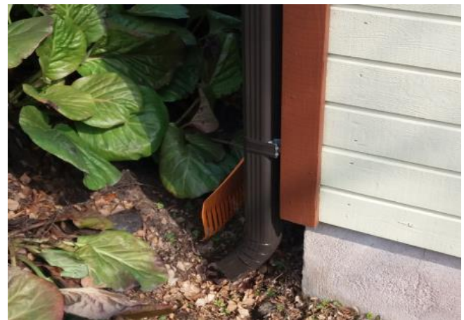
Kuva 16. Molempien autokatoksen takaosista syöksytorvien alapuolelta rännikävot puuttuvat.
