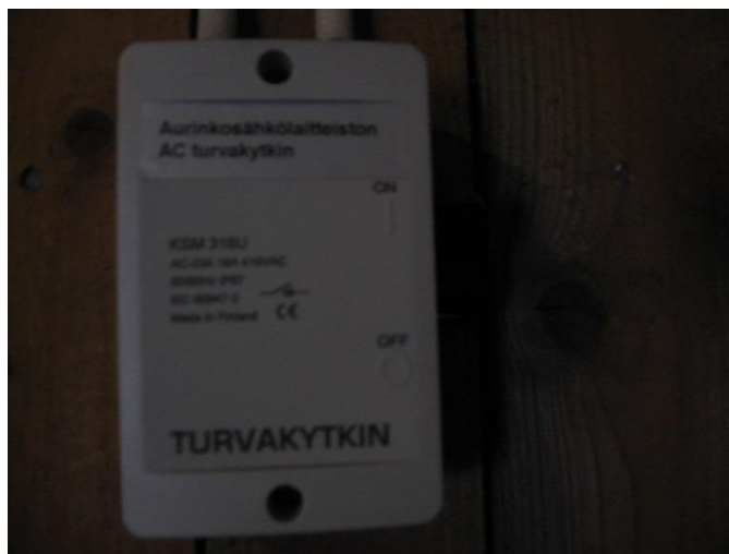
Kuva 11. Aurinkosähköjärjestelmän turvakytkin (Joutsimatka)
