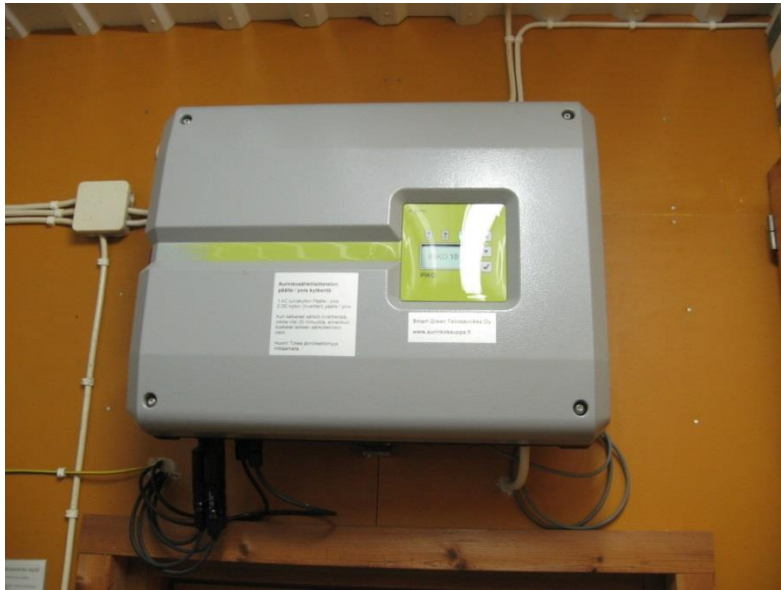
Kuva 15. Asennettu stringi-inverteri sikalan teknisessä tilassa.
