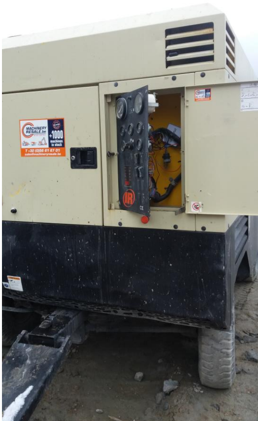
KUVA 7. Ingersoll Rand kompressorista löytyi ohjauspaneelin takaa suojaisa paikka, josta sai otettua käyttövirran laitteelle.
