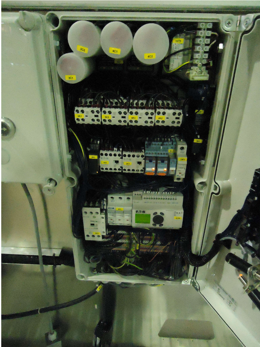
Kuva 4. Ohjauskeskuksen kuva sisältä.
