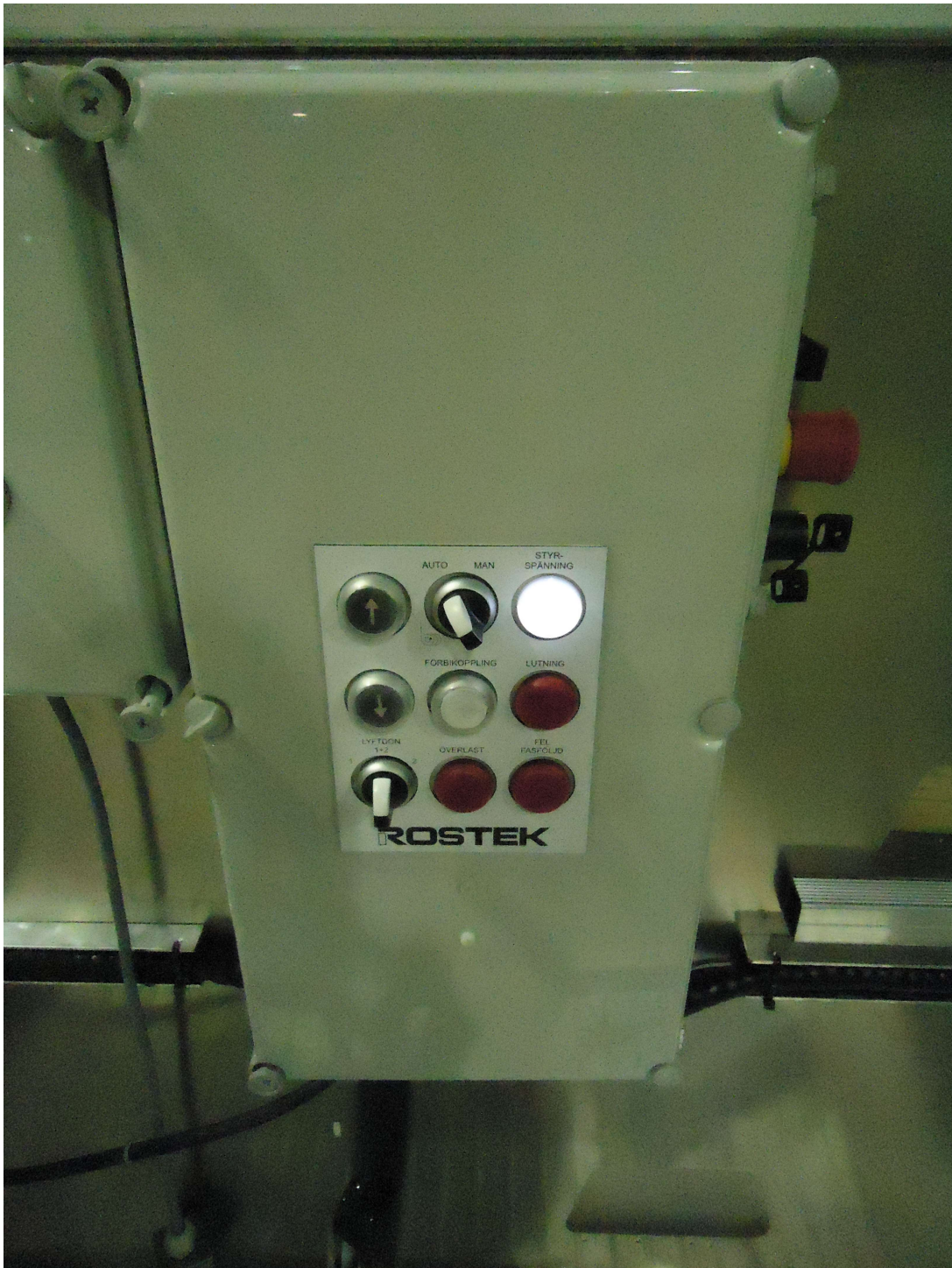
Kuva 2. Ohjauskeskuksen paneeli. Ruotsinkielisillä opastekyllillä varustettu.
