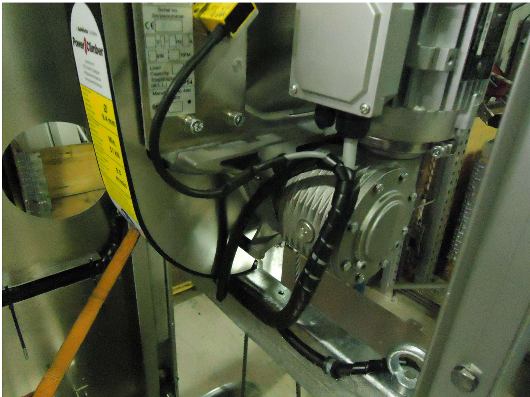
Kuva 12. Kaapelin jatkos ylikuormarajakytkimelle.
