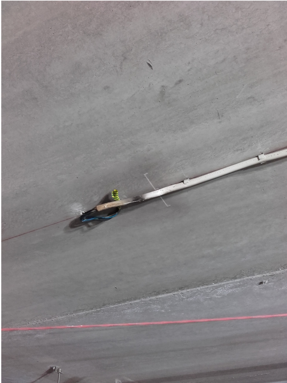
Kuva 2 Lämmöstä kärsinyt valaisimen syöttökaapeli.
