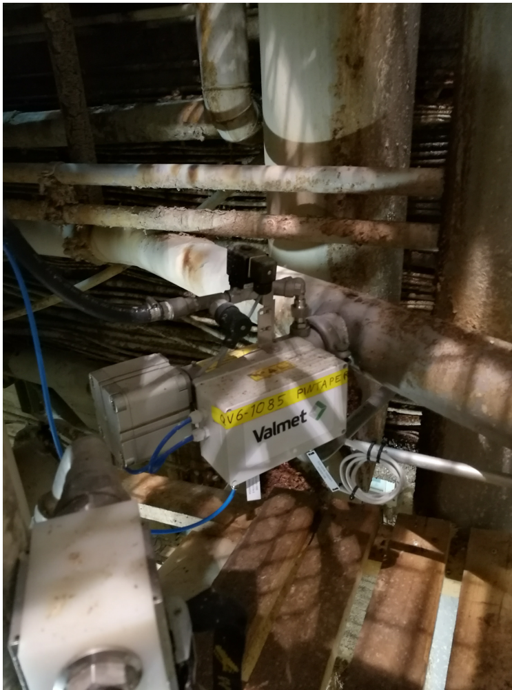
KUVA 19. Pinnan perälaatikon automaattinen näytteenottoventtiili
