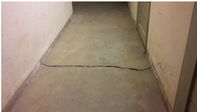
Kuva 20. Kellarikäytävän lattian murtuma.
