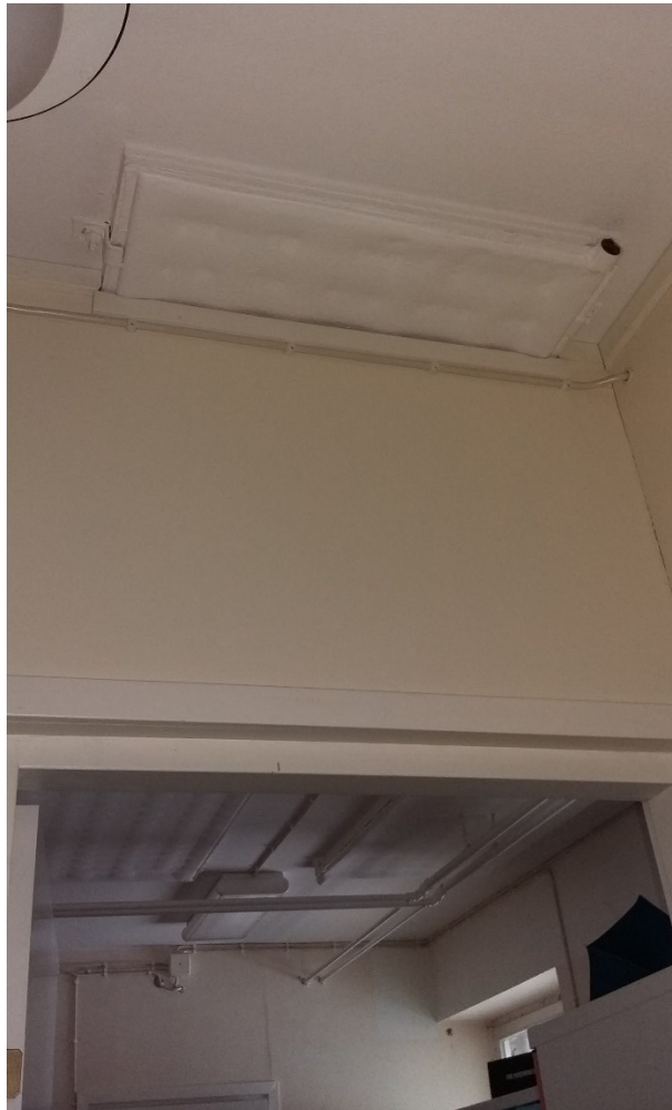
Kuva 8. Alkuperäisen keittiön katossa sijainneet lämmityspatterit
