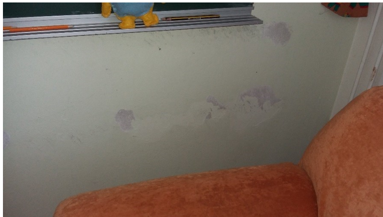
Kuva 21. Esikouluhuoneen seinän rappaukset irronneet.
