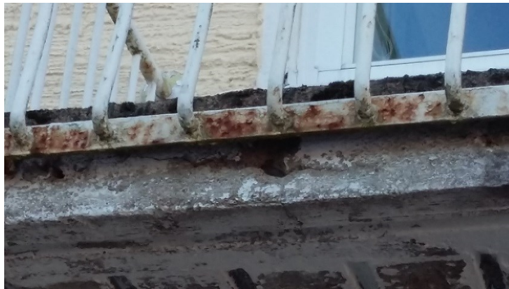
Kuva 12. Parvekkeen huonokuntoinen betonirakenne
