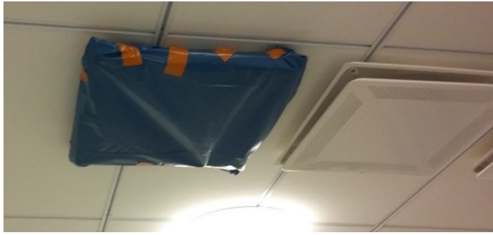
Kuva 11. Keittiön yksi poistoilmakanavista suljettuna.
