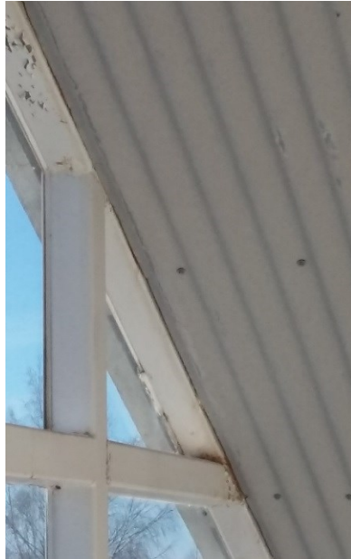
Kuva 15. Pelastuskäytävän teräsrakenteiden alkava korroosioaurio.
