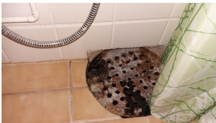
Kuva 27. Miesten suihkutilan lattiakaivo.
