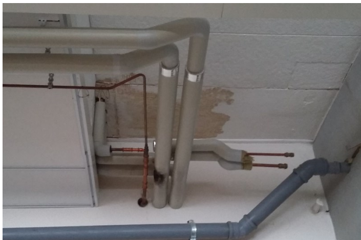
Kuva 2. Puutyöluokan katossa oleva vesivahingon jälki
