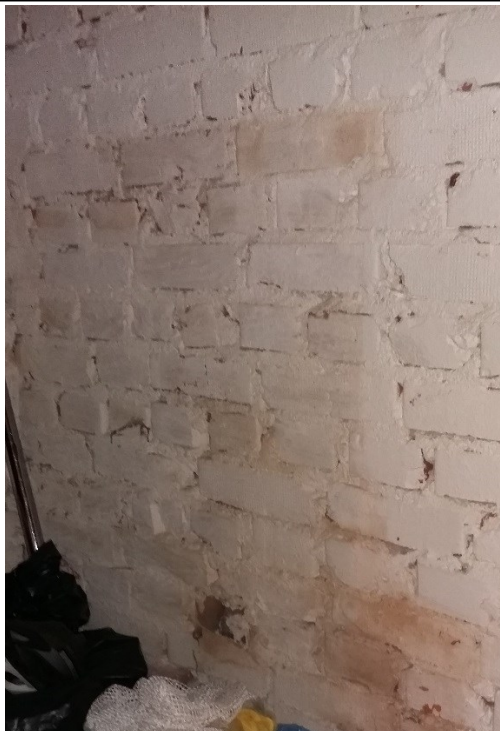
Kuva 28. Kellarikomeron tiiliseinän värjäymä.
