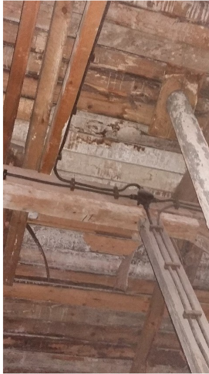
Kuva 17. Kouluusiiven katon vesivahingon jälki
