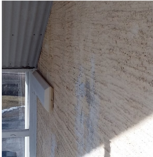
Kuva 14. Pelastuskäytävän seinän valumajälkiä
