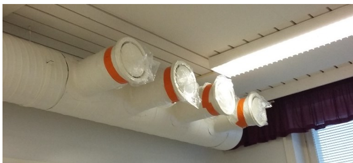
Kuva 10. Ruokasalin poistoilmakanavat tiivistettyinä
