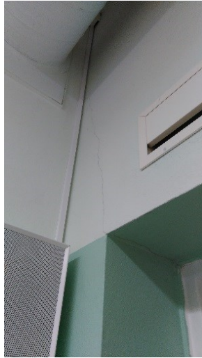
Kuva 8. Murtuma luokkahuoneen oven yläreunassa.
