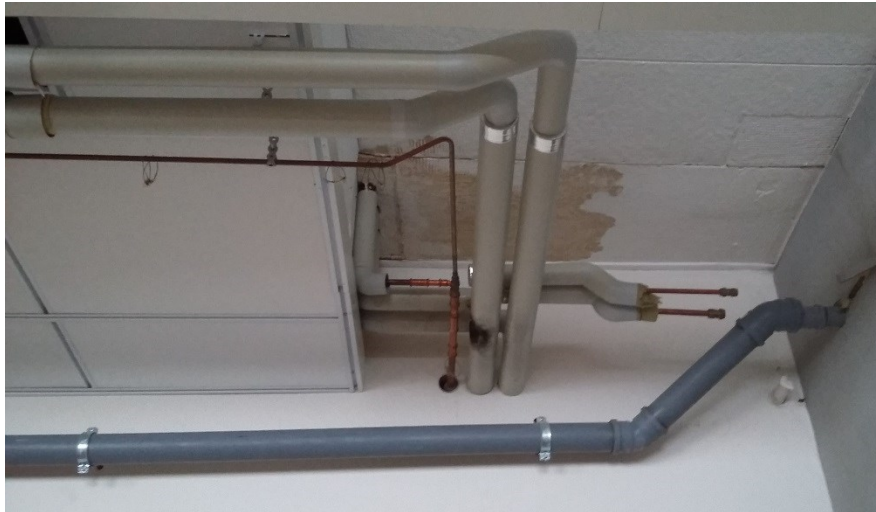
Kuva 9. Puutyöluokan katossa näkyvä vanhan vesivahingon jälki
