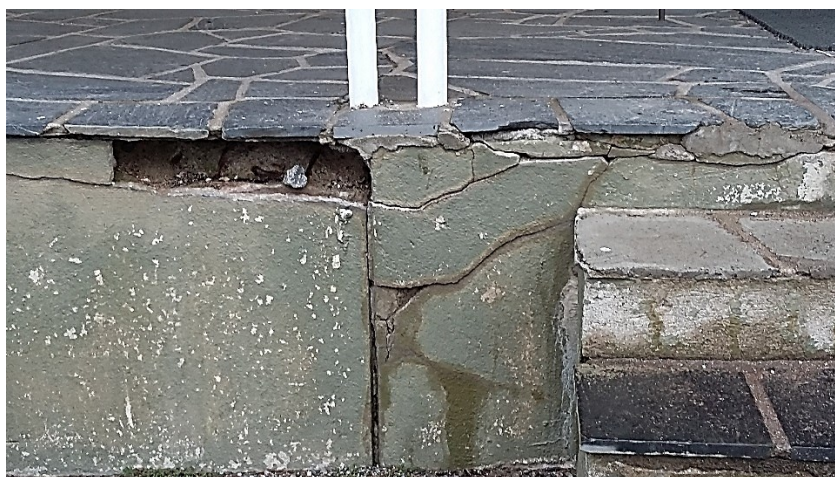
Kuva 24. Pääsisäänkäynnin laiturin betonivaurioita
