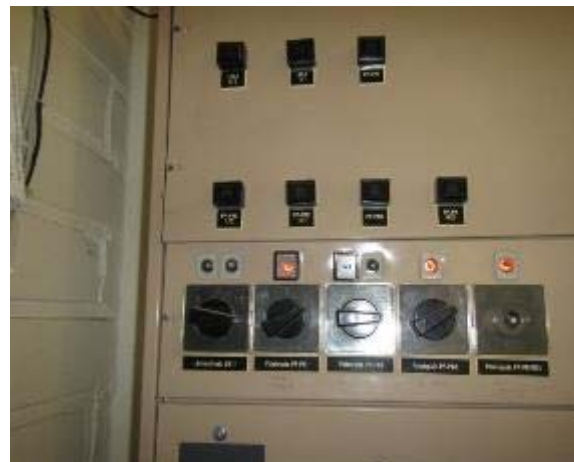
Kuva 26. IV-koneiden käyttökytkimet. Kytkimet käsikäytöllä 1/1 -asennossa, mutta koneet pyörivät \frac{1}{2} -teholla!
