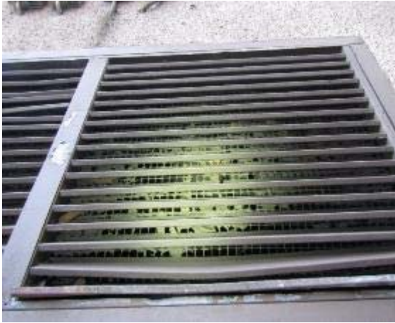
Kuva 4. Raitisilmasäleikkö on likainen ja osittain tukossa lehtiroskista. Säleikkö tulee puhdistaa.
