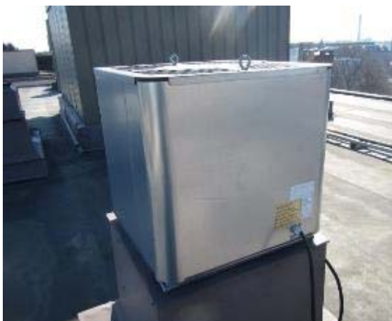
Kuva 53. Päiväkodin poistoilmakone PK-7 oli uusittu vuonna 2008.
