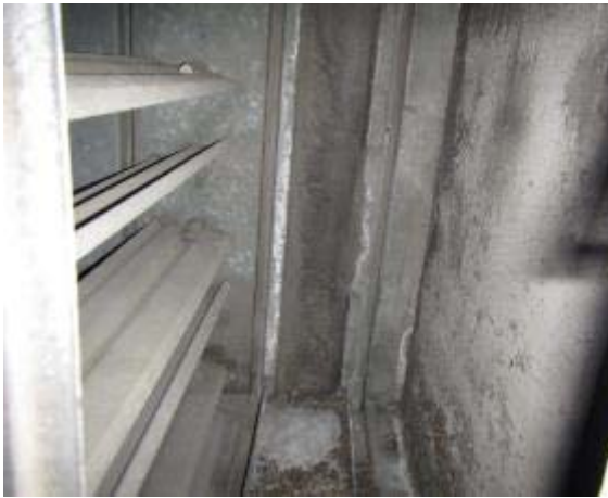
Kuva 6. Raitisilmapelti on toimiva. Suodatinosan luukku oli epämääräisesti paikoillaan, ja konehuoneen ilmaa pääsee koneen sisälle luukun kautta.
