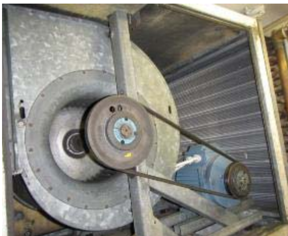
Kuva 47. Puhallin oli likainen. Sähkömoottori oli uusittu aiemmin.
