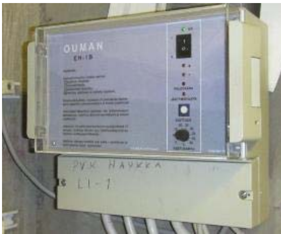
Kuva 25. Tuloilmakone LIK-1 lämmityksen säädin.
