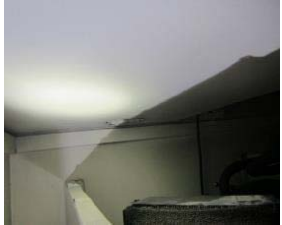
Kuva 66. Poistoilmaventtiili oli pois paikoiltaan.
