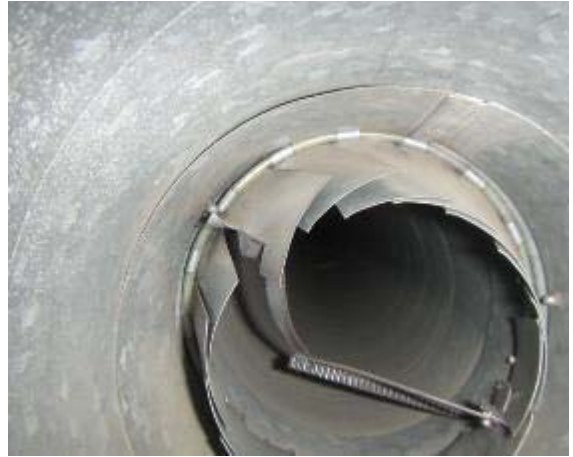
Kuva 15. Kokoustila. Tuloilmakanavassa on vanha iirispelti rikkoontuneena ja pölyä runsaasti.
