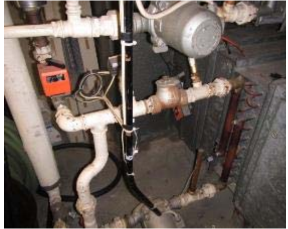
Kuva 13. Lämpöpumppu on alkuperäinen. Lämmityksen 2-tieventtiili oli uusittu. Lämpötilan säätöanturi on heikosti kiinni putkessa.
