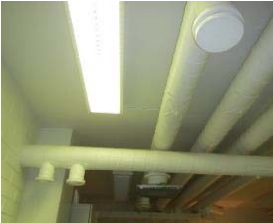
Kuva 21. Kokoustilan tuloilman päätelaitteesta ei tule ilmaa. Säätäpelti oli lähes kiinni asennossa.
