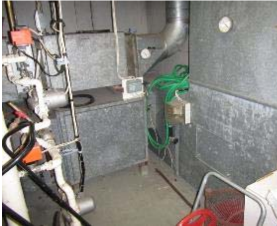
Kuva 12. IV-konehuone. Alempana kuvassa LPK Haukan tuloilmakone. Tilassa on paljon varastoituna tavaraa.
