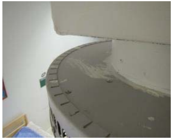
Kuva 62. Tuloilmaelimen päällä oli huomattavasti pölyä.
