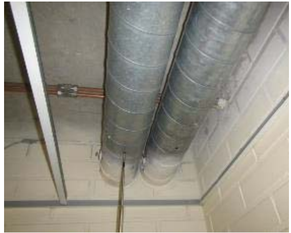
Kuva 17. Tuloilmakanavia alaslaskun yläpuolella.
