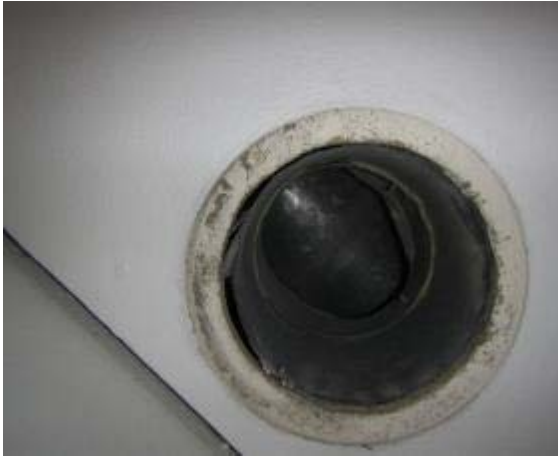
Kuva 14. Kanavaosa poistoilman runkokanavaan on erittäin likainen.
