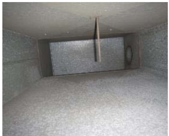
Kuva 9. Tuloilmakanavassa on paljon pölyä ja likaa.
