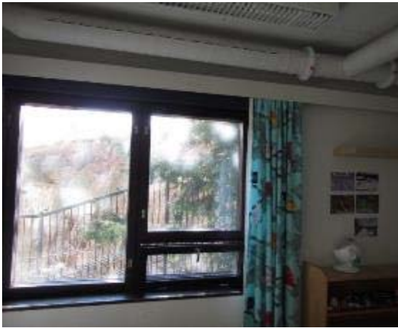
Kuva 16. Ryhmähuoneiden tuloilmakanavat on varustettu säätöpelleillä.
