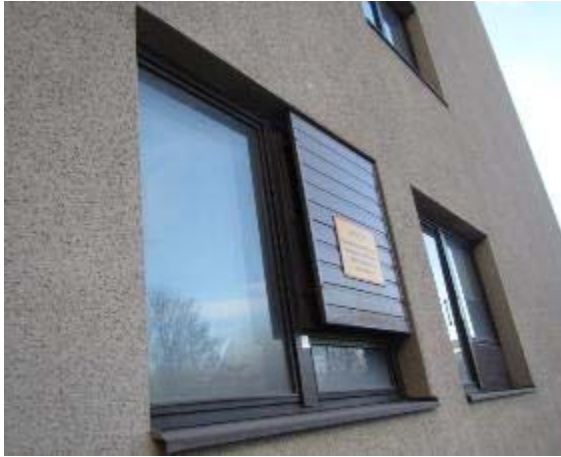
Kuva 41. Raitisilmasäleikön suojapelti rakennuksen eteläseinällä.
