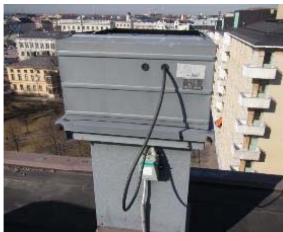
Kuva 54. Keittiön poistokone PK-2 vm. 1995.
