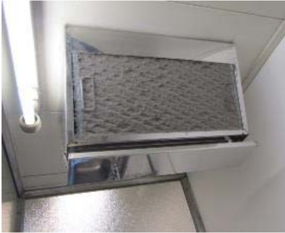
Kuva 19. Keittiön poistoilman rasvasuodatin oli tukossa.
