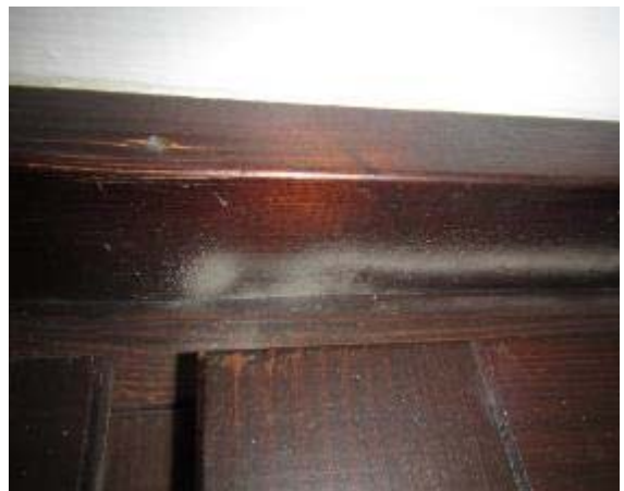
Kuva 28. Ilmavuotoa ikkunan karmin ja tiivisteen välistä.
