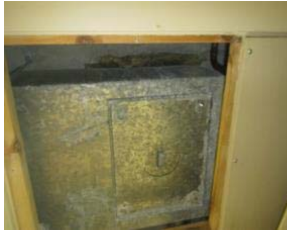
Kuva 56. Poistoilmakanavassa oli jälkiä aikaisemmin tapahtuneesta vesivuodosta.
