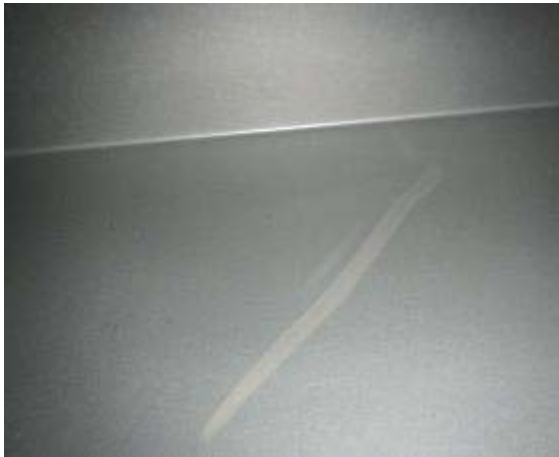
Kuva 59. Keittiön tuloilmakanavassa oli pölyä (sormitesti).
