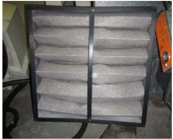
Kuva 7. Suodatin on kunnossa ja vaihto tehty aiemmin. Suodatinluokasta ei ollut merkintöjä.
