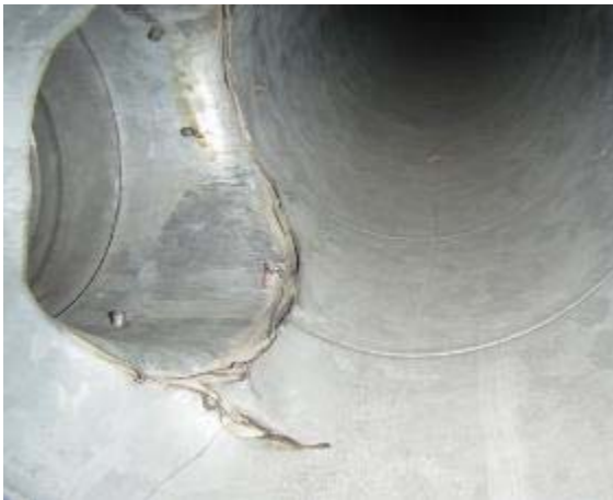
Kuva 57. Ryhmähuoneen H4 tuloilmakanavassa oli pölyä.
