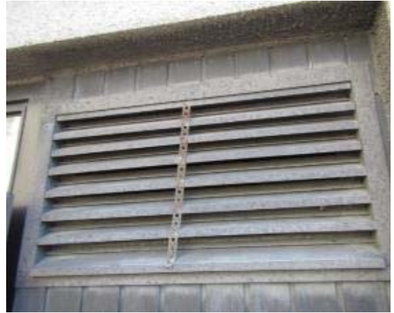
Kuva 42. Ruosteinen ja likainen raitisilmasäleikkö, jonka suojuus poistettiin tarkastusta varten.
