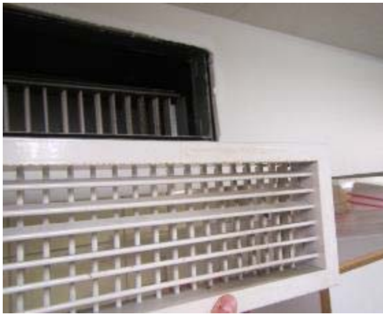
Kuva 61. Keittiön tuloilmasäleikkö. Hieman likaa ja rasvaa.
