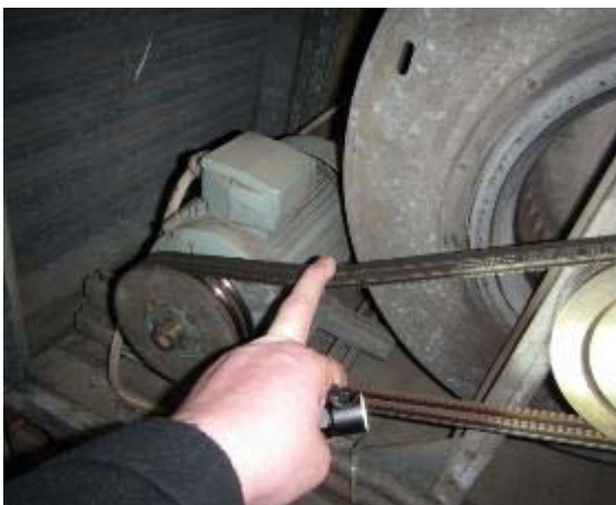
Kuva 8. Puhallin on likainen, ja kiilahihnat ovat löysällä.
