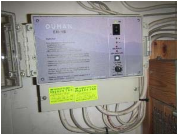
Kuva 69. Tuloilmakone LIK-1 lämmityksen säädin.
