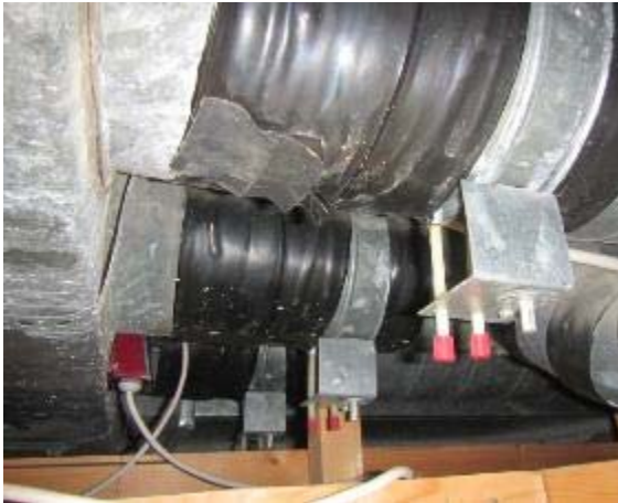
Kuva 55. Poistoilmakanavien säätöpellit levykaton yläpuolella.
