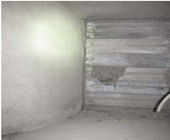
Kuva 43. Raitisilmakammion oli erittäin likainen ja pölyinen. Raitisilmapellissä oli kiinnittynyt muovia.
