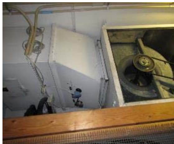
Kuva 48. Tarkastusluukun kansi ei ollut tiivis
