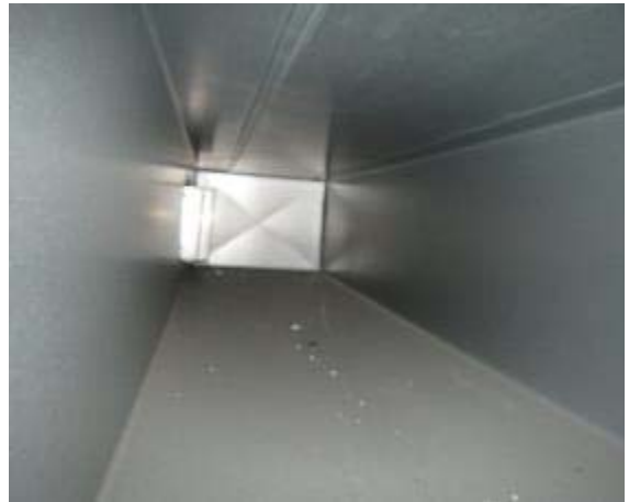
Kuva 60. Keittiön tuloilmakanavan pohjalla epäpuhtauksia ja irtoainesta.
