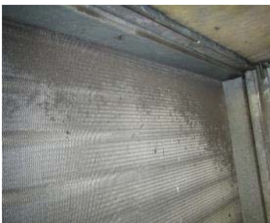
Kuva 45. Lämmityspatteri oli yläreunasta tukossa.
