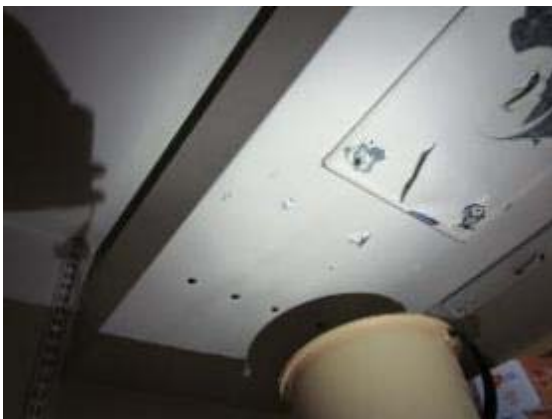
Kuva 18. Siivouskomeron tuloilmakanavan yläpuolelta oli ollut aiemmin vesivuotoa.
