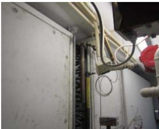
Kuva 51. Tilojen tuloilmakone LIK-1.
