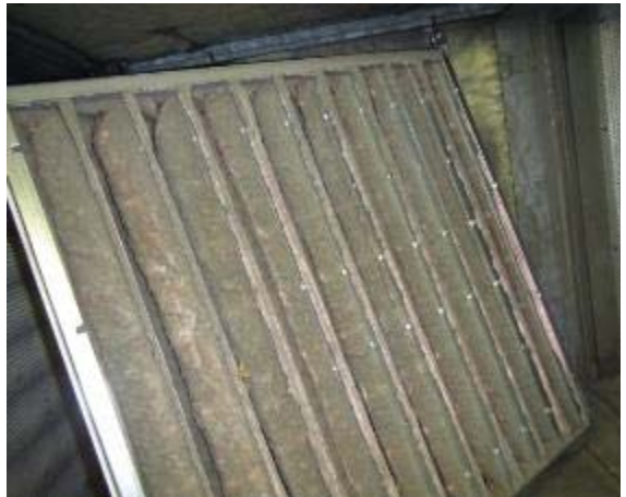
Kuva 44. Tuloilman pussisuodatin oli likainen.
