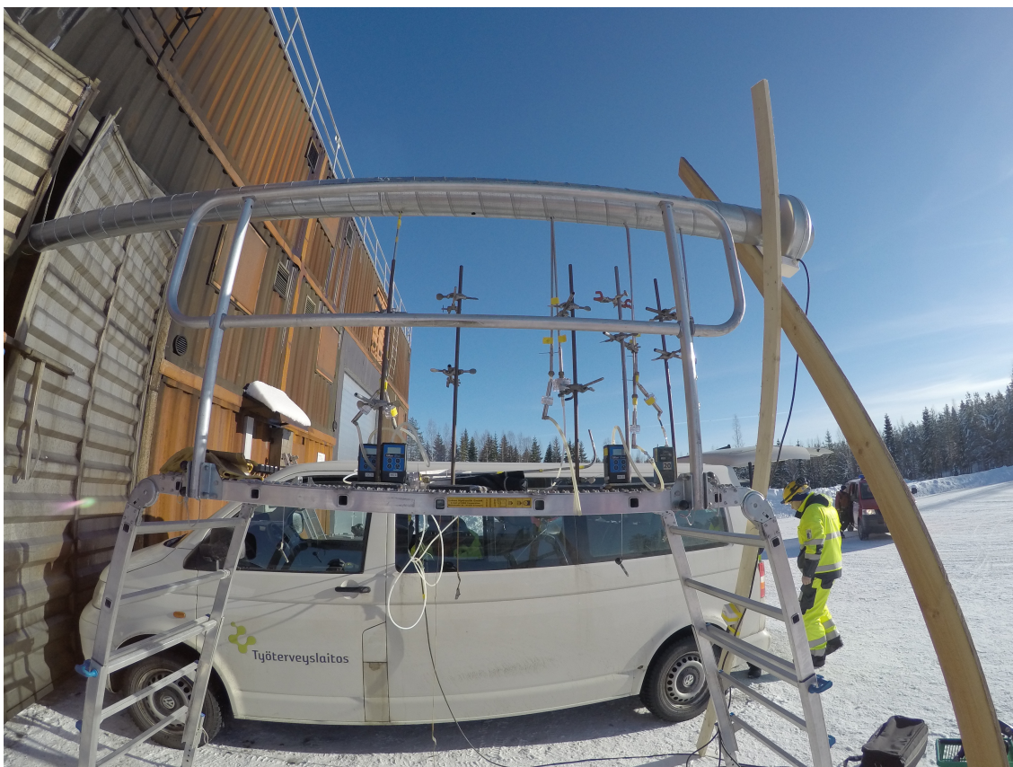
Kuva 36. Savukaasujen poistokanavisto. Keskellä mittasondit sekä oikealla kanavapuhallin.
