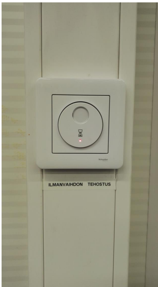
Kuva 10. Kuntosalissa sijaitseva ilmanvaihdon tehostuspainike
