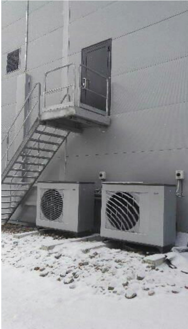
Kuva 6. Ulkona sijaitsevat ilma-vesilämpöpumput
