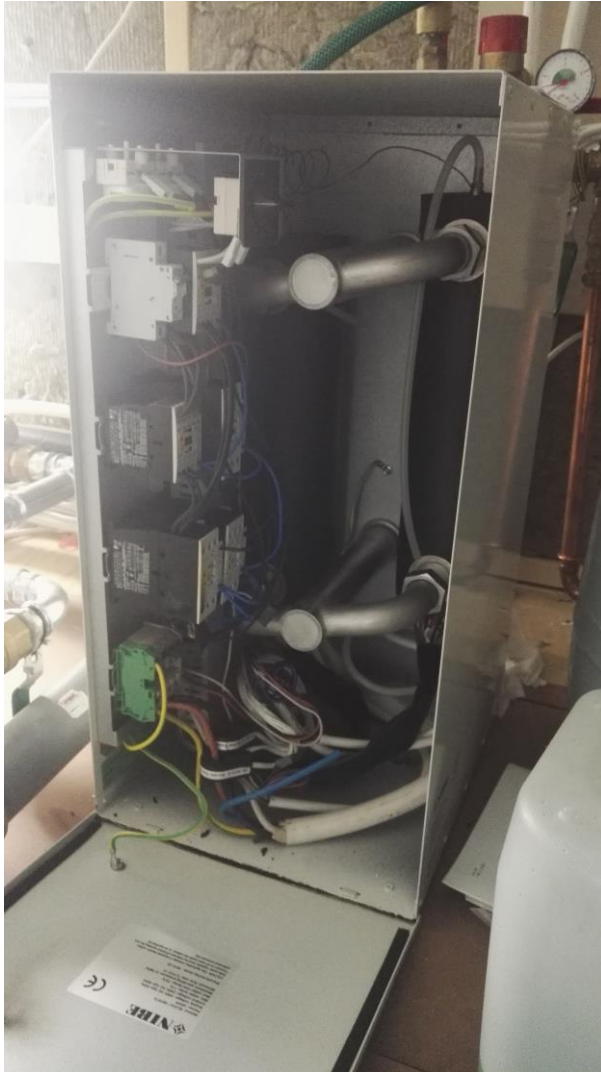
Kuva 7. IV-konehuoneessa sijaitseva NIBE ELK-42 sähkökattila
