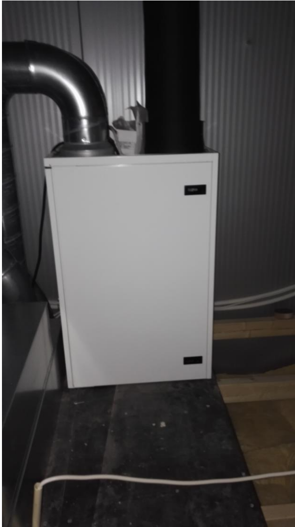
Kuva 4. Neuvottelutilan välikatossa sijaitseva Iloxair 129 (R) LTO-kone
