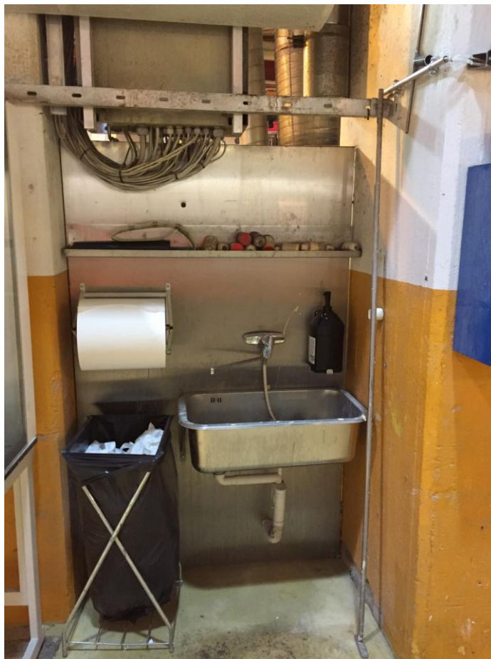
Kuva 1. Lavuaarin ympäristön kunto lähtötilanteessa
