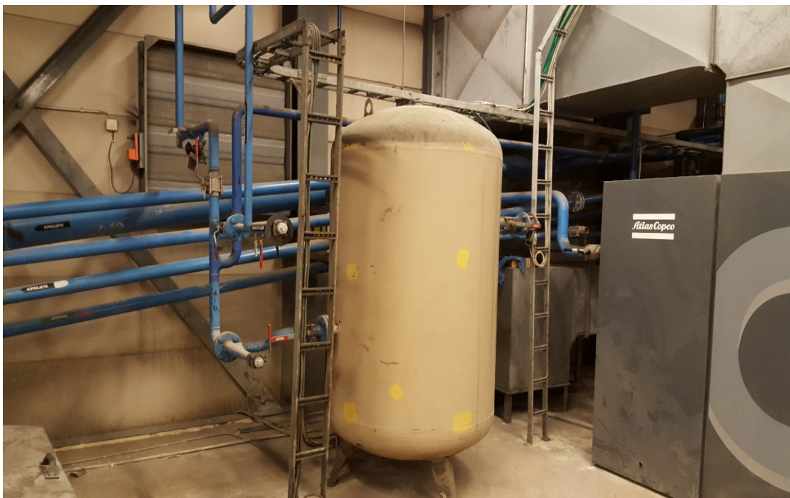
Kuva 8. Kompressorin API657695 ja prosessiputket.
