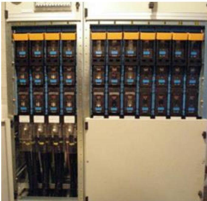
Kuva 3. Muuntamon pienjännitekojeisto (Veli-Pekka Lempiö)
