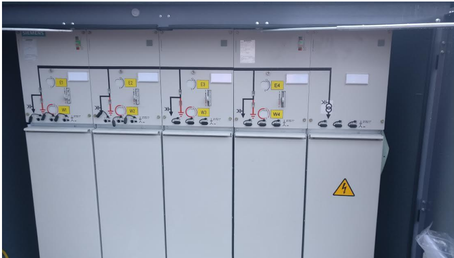
Kuva 2. Muuntamon keskijännitekojeisto (Veli-Pekka Lempiö)
