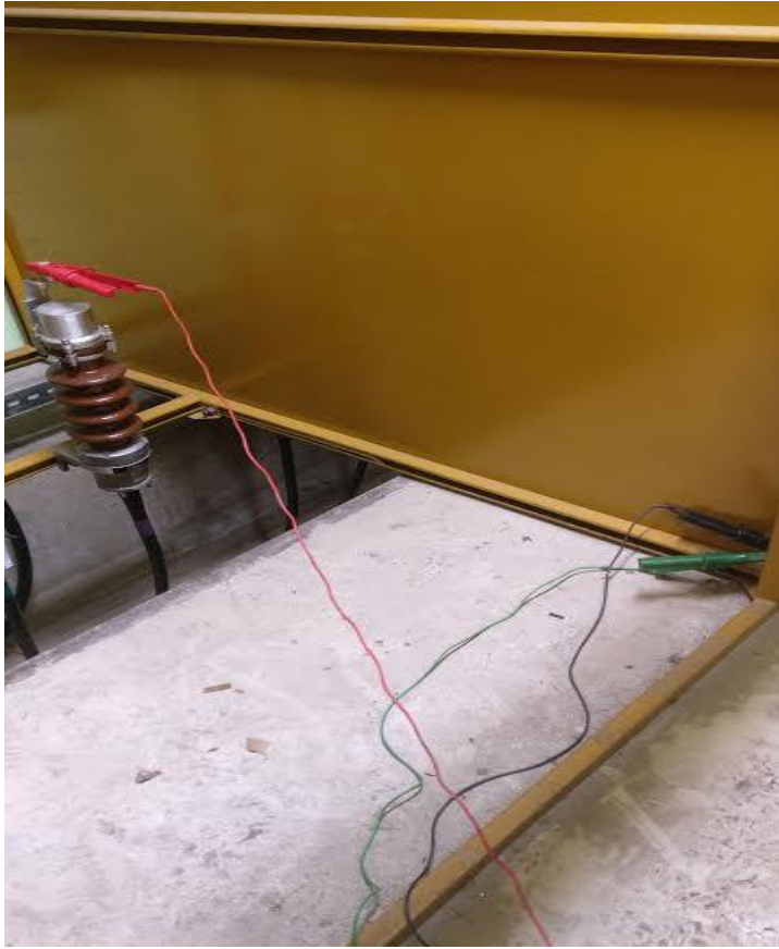
Kuva 11. Eristysvastusmittauksen kytkentä (Veli-Pekka Lempiö)
