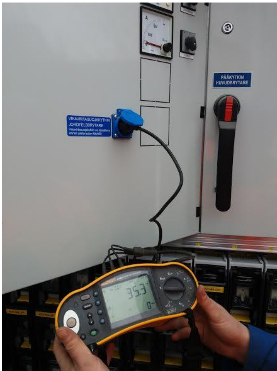
Kuva 17. Vikavirtasuojan mitattu laukaisuaika (Veli-Pekka Lempiö)
