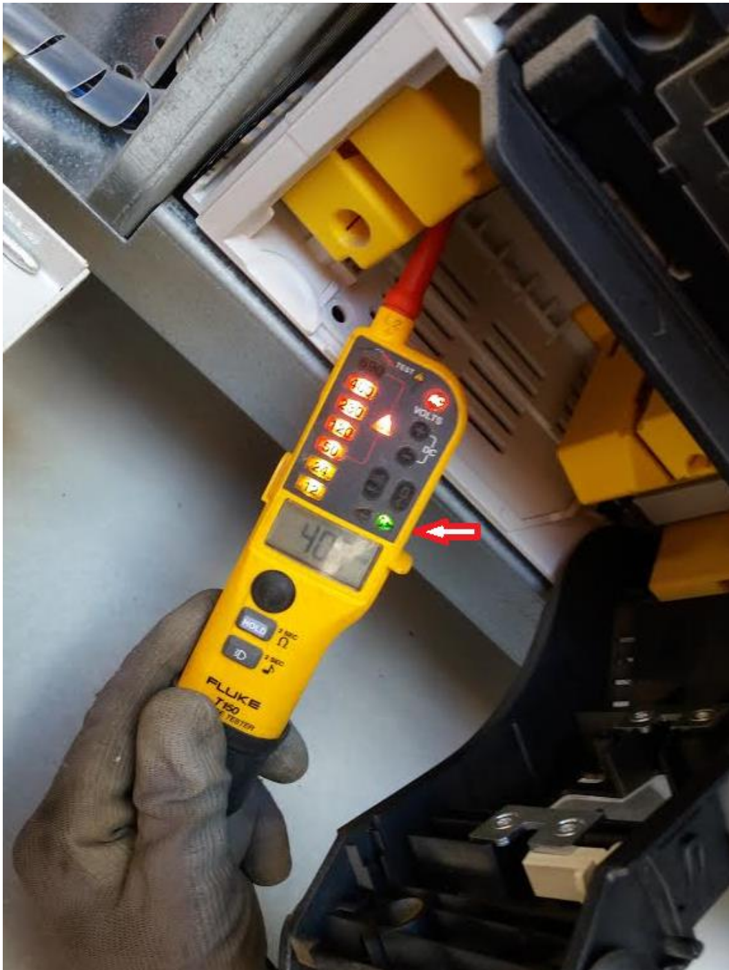
Kuva 14. Kiertosuunnan mittaus Fluke T150 sähkötesterillä jonovarokeytkimestä (Veli-Pekka Lempiö)
