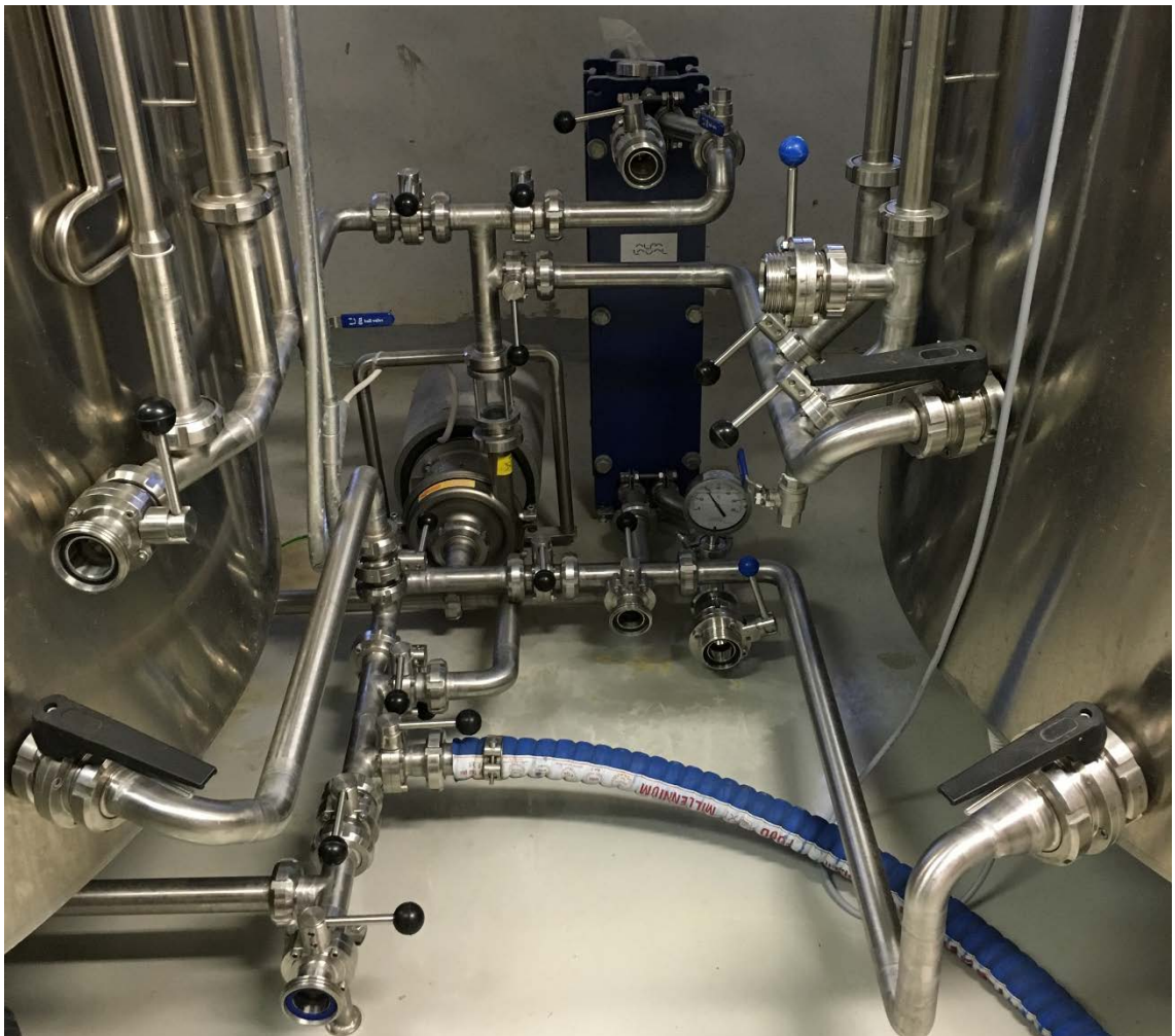
Kuva 5. Keskipakopumppu, levylämmönvaihdin ja laitteiston putkisto.
