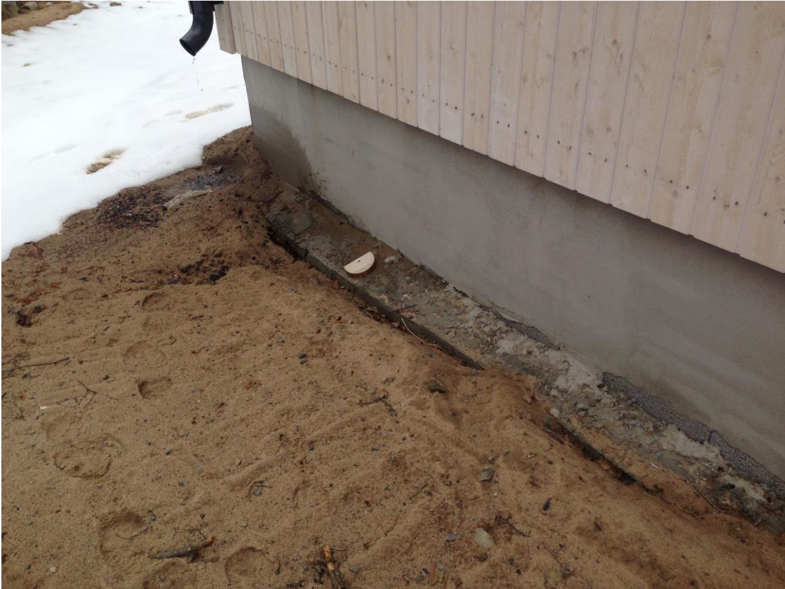
KUVA 4. Puuttuvat routaeristeet ja sadevesijärjestelmä
