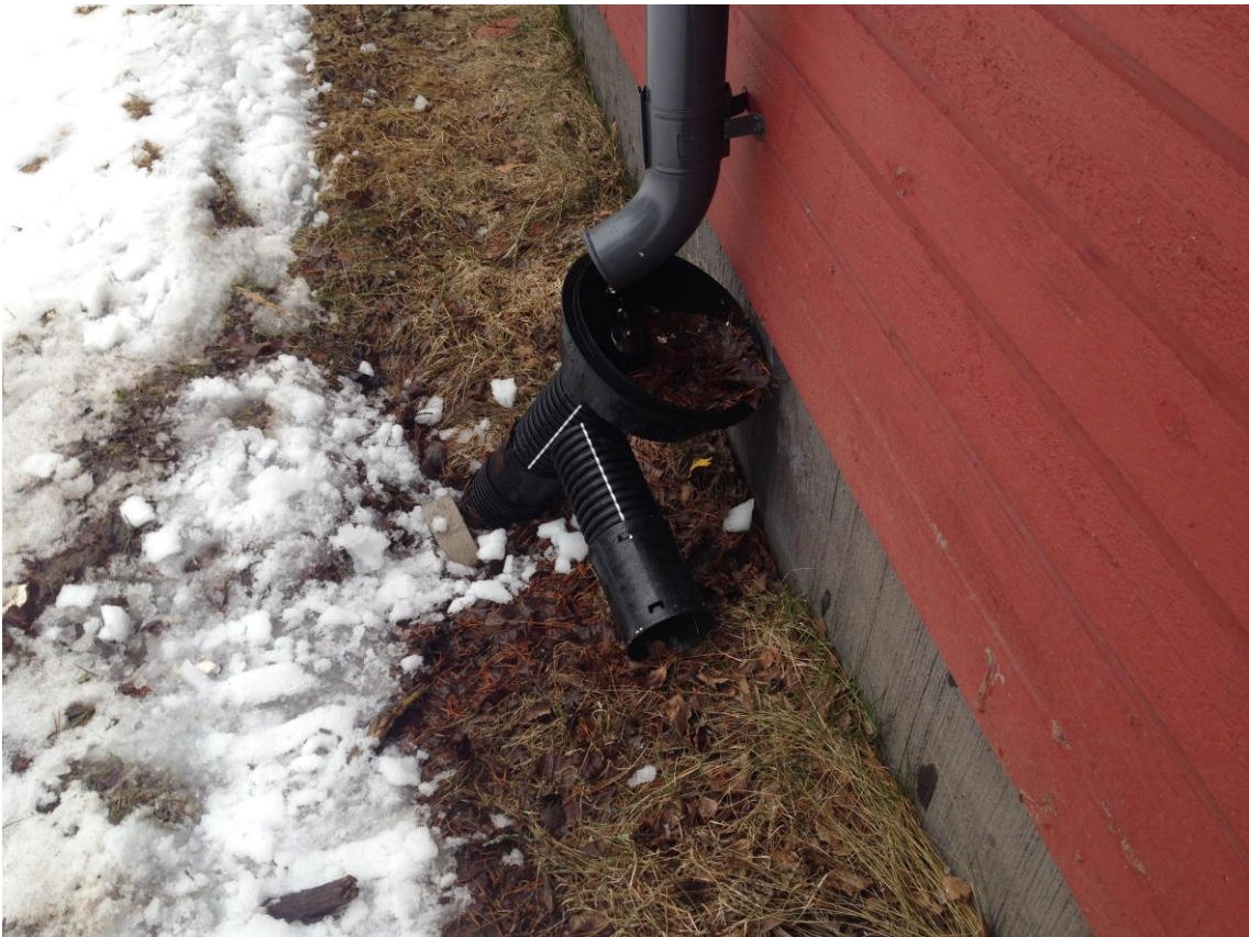
KUVA 5. Huonosti asennettu sadevesikaivo
