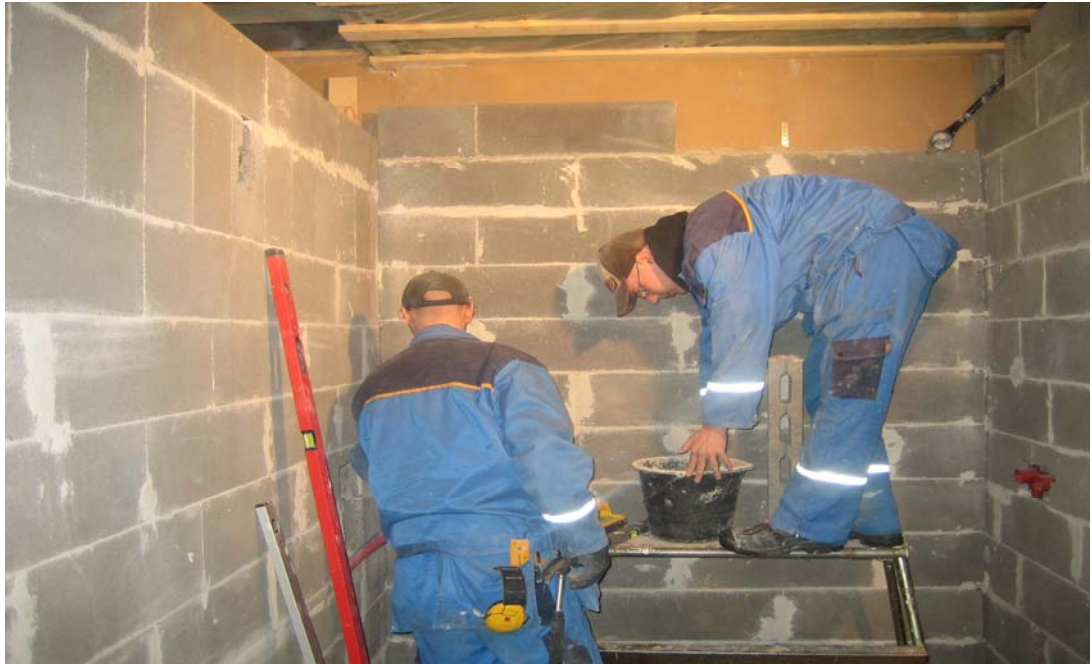
Kuva 9. Kosteiden tilojen seinämuurausta harkolla. Työ on vielä hieman kesken. Tämän jälkeen on vuorossa seinien tasoitus. Kimmo ja Keijo Mikkonen tekevät opinnäytetyötään
