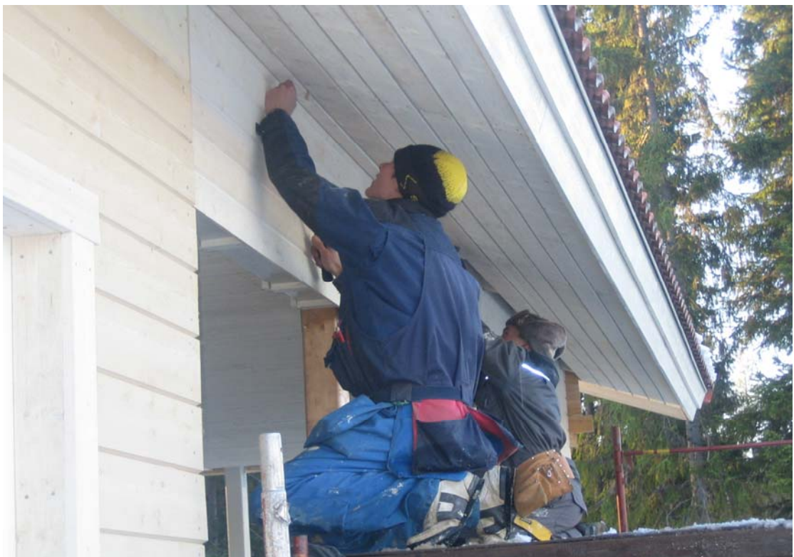
Kuva 6. Rästäslautojen asennustyössä Tuomas Heikkinen ja Lauri Keränen. He mittaavat lautojen välit saman levyisiksi, jota laudat tulevat suoraan.
