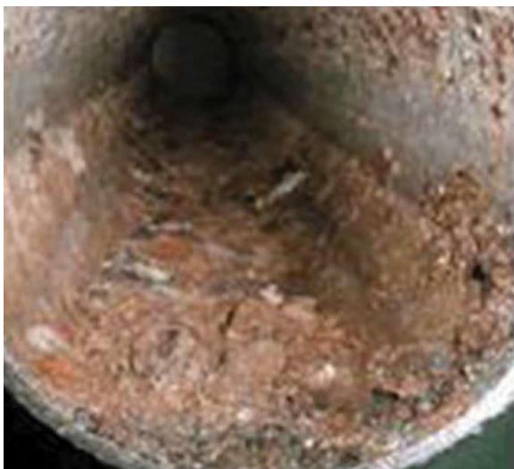
Kuva 5. Vedenaiheuttamaa korroosiota kaasusäiliössä.
