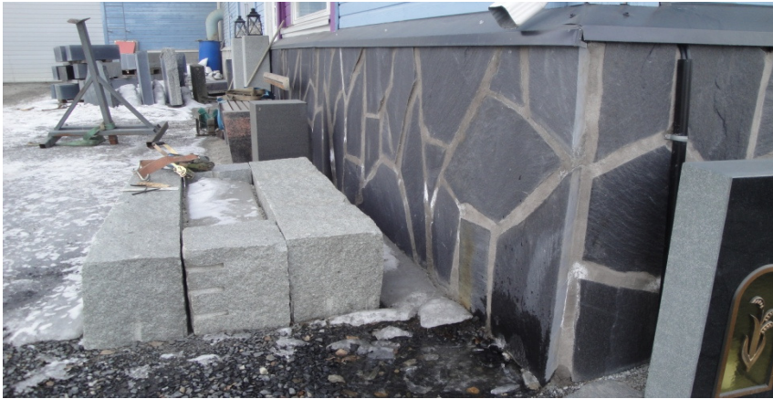
Kalkkeutuma sokkeleissa kertoo huonosta maapohjan kuivatuksesta.
