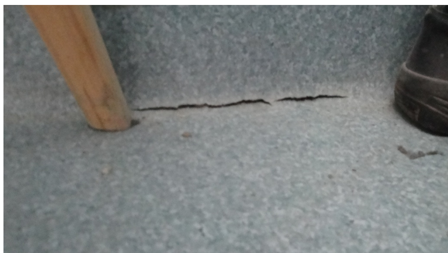
Pukuhuoneen lattiamatto on revennyt. Muutoin mattopinnat ovat eheät ja hyväkuntoiset.
