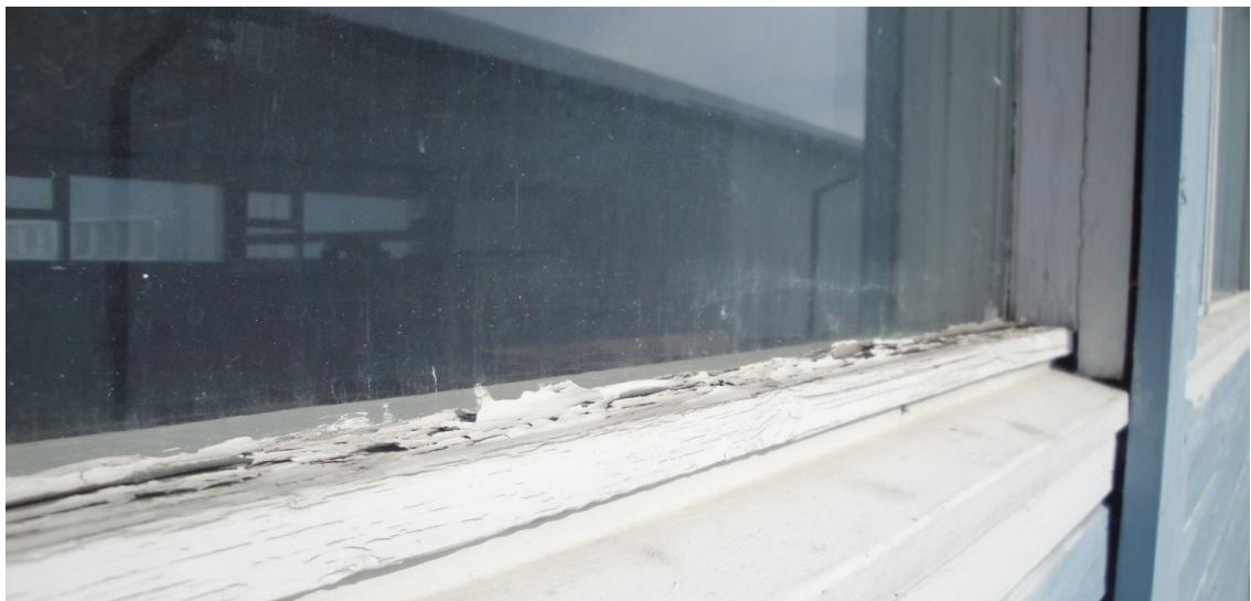
Kultaushuoneen ikkunaa ulkopuolelta kuvattuna. Ikkunoiden puitteiden maalivauriot ovat huomattavat. Lisäksi lasikittaukset ovat lohkeilleet laajalti pois.
