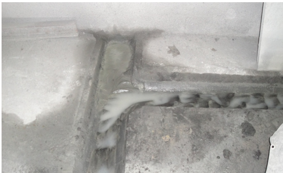
Vedenpoistokouru ei toimi tehokkaasti tukkeutuneena.
