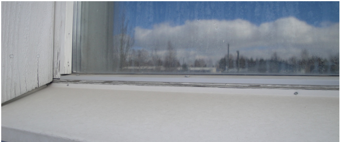
Hallin ikkunaa ulkopuolelta kuvattuna. Ikkunoiden tyypillinen vaurio on alapuitteiden nuu/maalivauriot huonosti toteutetun vedennoiston takia.
