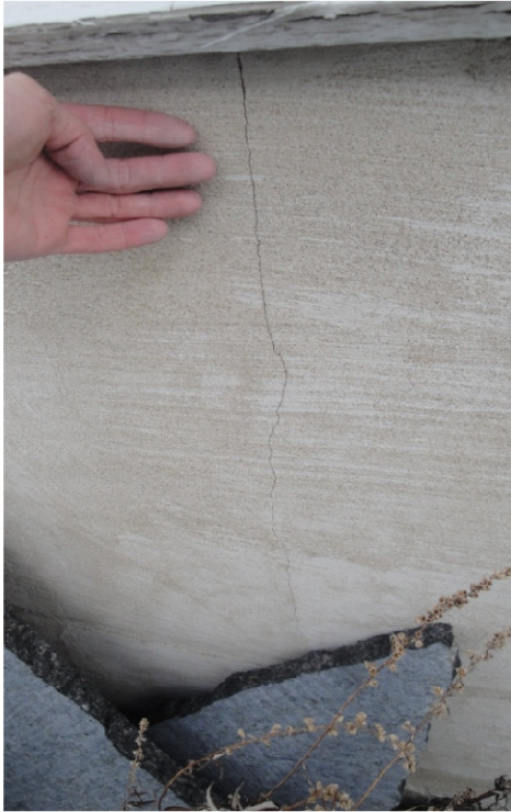
← Painumaan viit- taava halkeama lähellä lounais- kulmaa.
