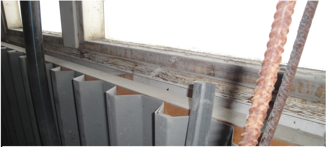
Hallin ikkunaa sisäpuolelta kuvattuna. Ikkunoista ei tahdo näkyä läpi likaisuuden vuoksi. Puitteiden maalivauriot ovat huomattavat.
