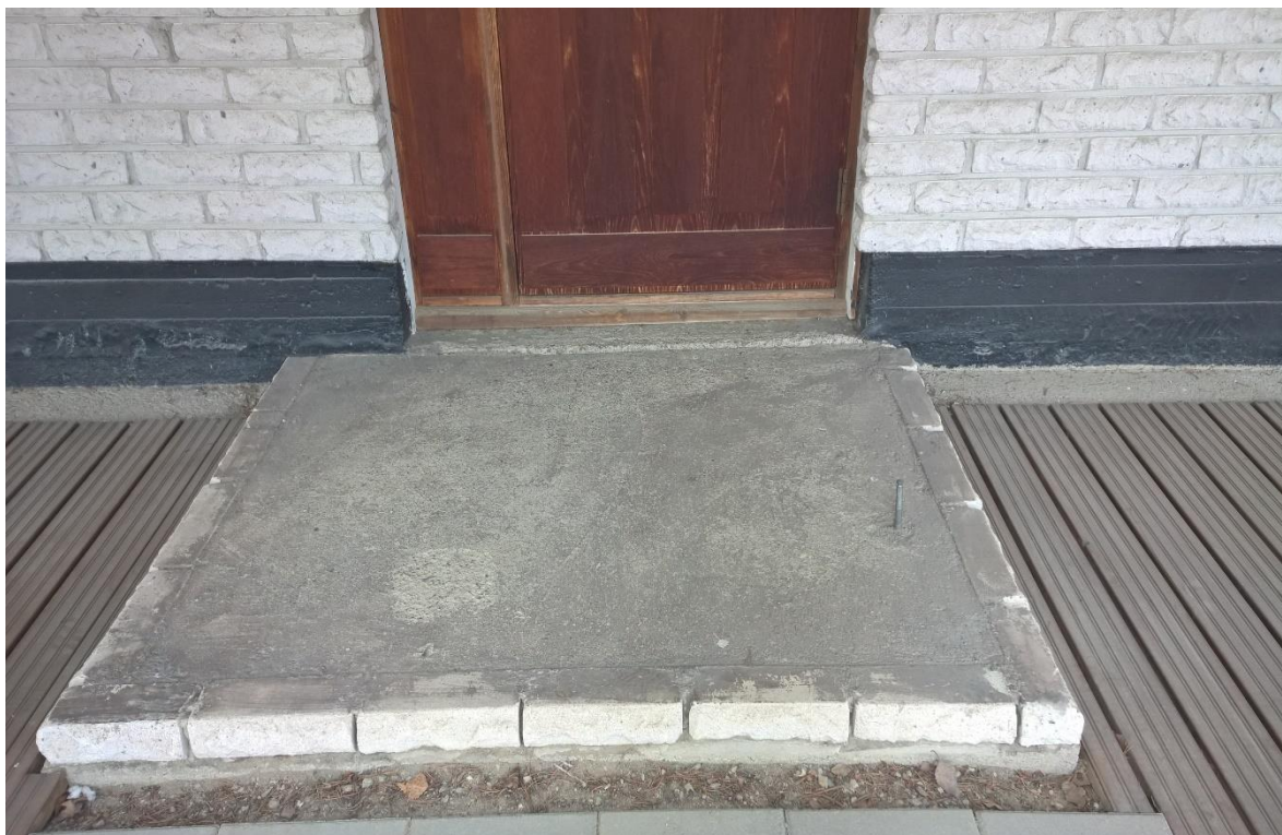
KUVA 6. Valesokkelin tunnistaa siitä, että sokkelin yläosa on korkeammalla kuin ulko-oven alareuna (Brandt 2017)
