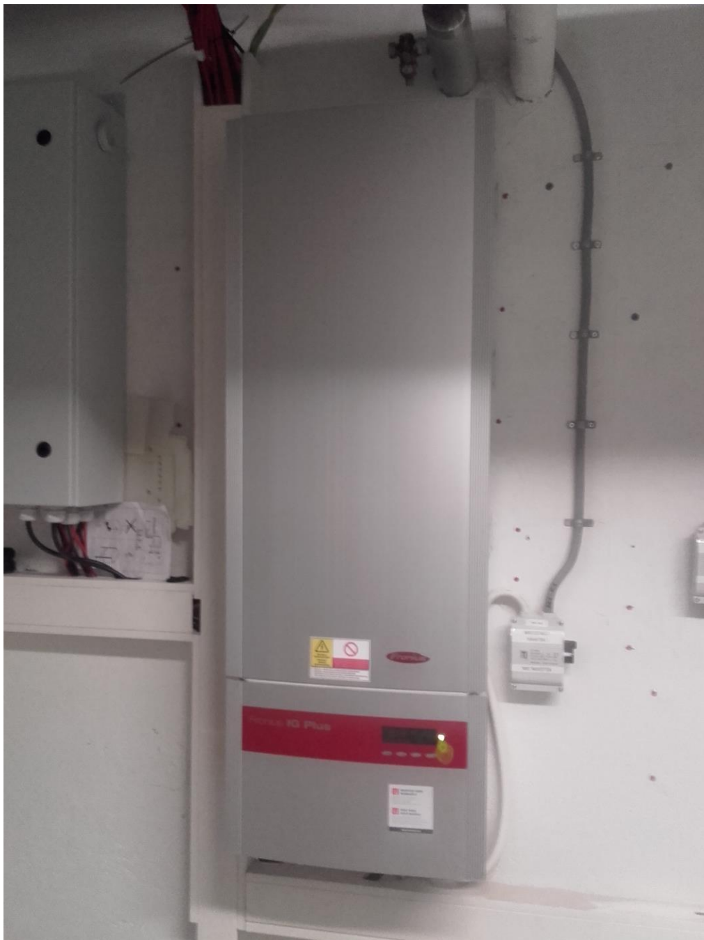
Kuva 13: Aurinkopaneeliseinän invertteri VXY rakennuksen kellarissa.
