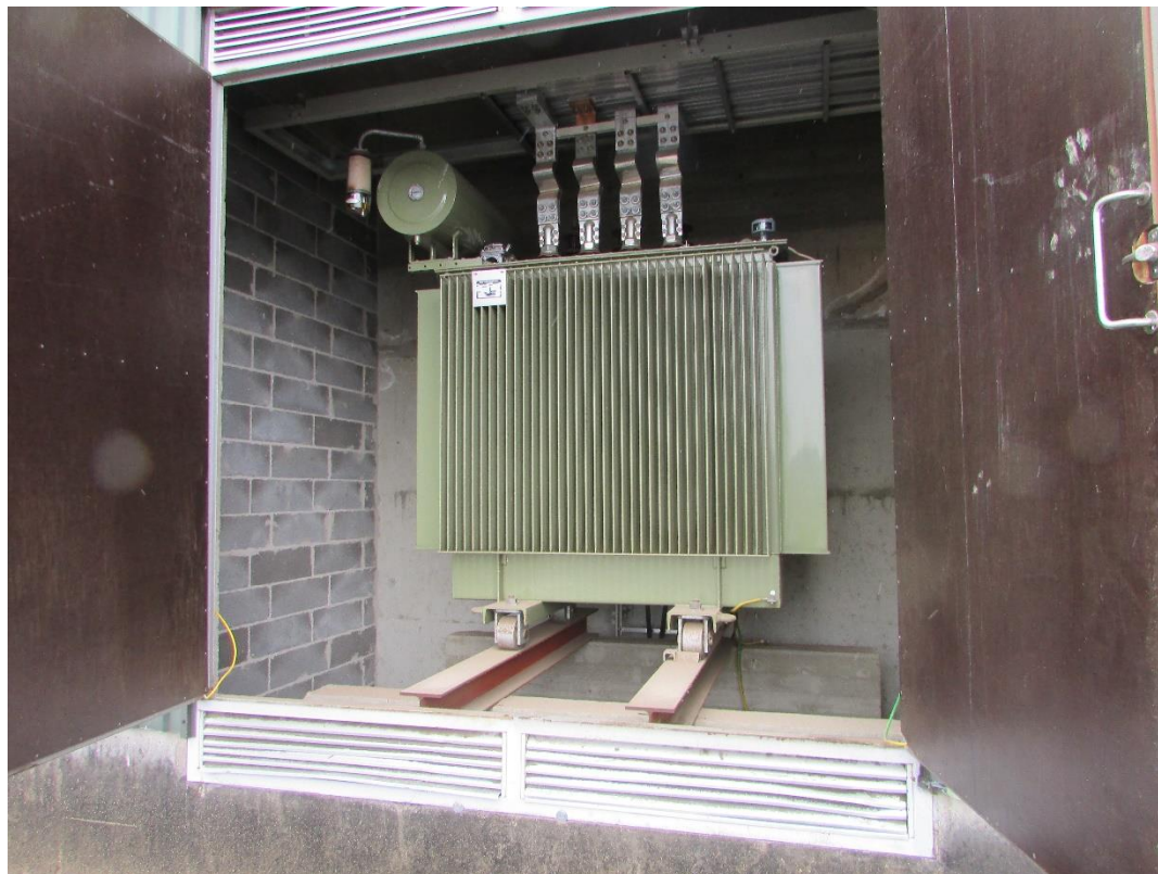
KUVA 3. Kuhmo Oy:n muuntaja T1 (Moilanen 2017.)
