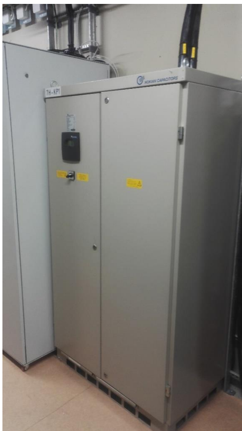
KUVA 10. 7H kompensointilaitteisto (Moilanen 2017.)
