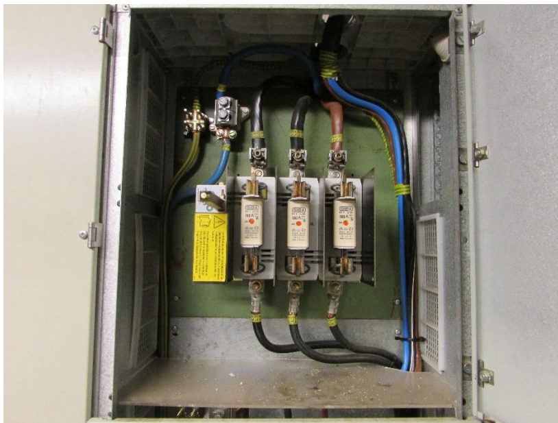
KUVA 12. Pumppaamon moottorin kytkinvarokelähtö (Moilanen 2017.)
