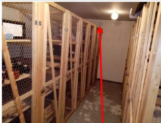
Kuva 2. A-talo Korvausilma venttiiliin paikka seinässä, mutta venttiili ja seinän sisäpinnan puhkaisu puuttuu.
