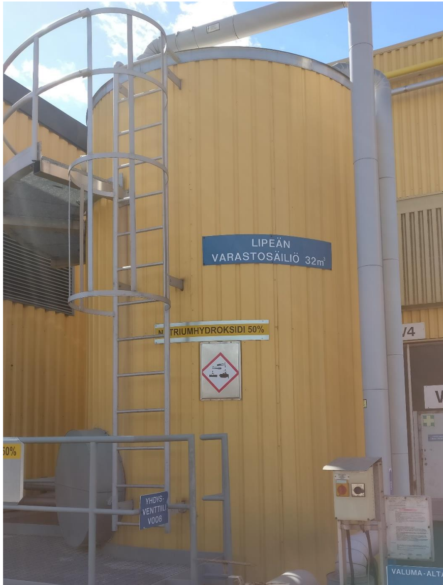
KUVA 11. Lipeän varastosäiliö, johon on toteutettu lämmitys kaukolämmöllä.
