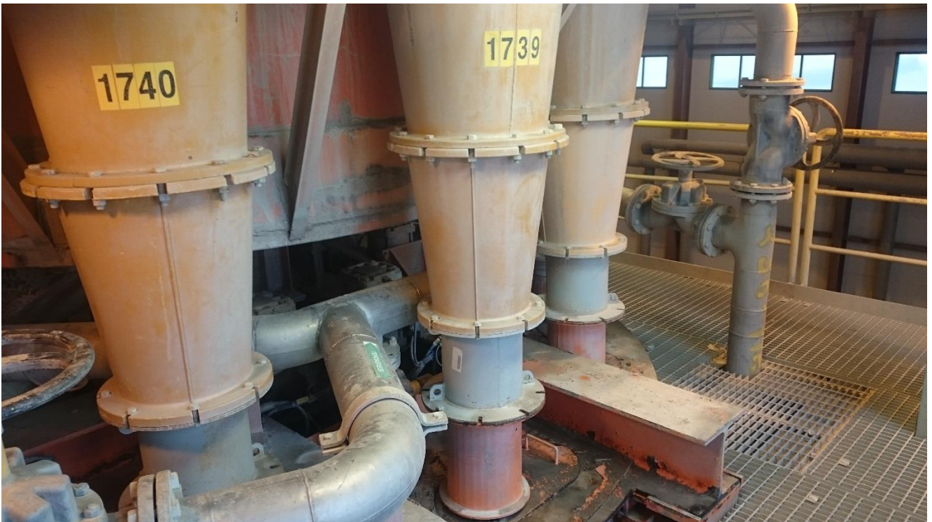
KUVA 6 Jauhimo 2:n hydrosyklonipatteristo
