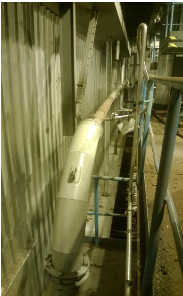
Kuva 3 Hiekan palautus putki kattilaan (Kuva Petri Niemi)
