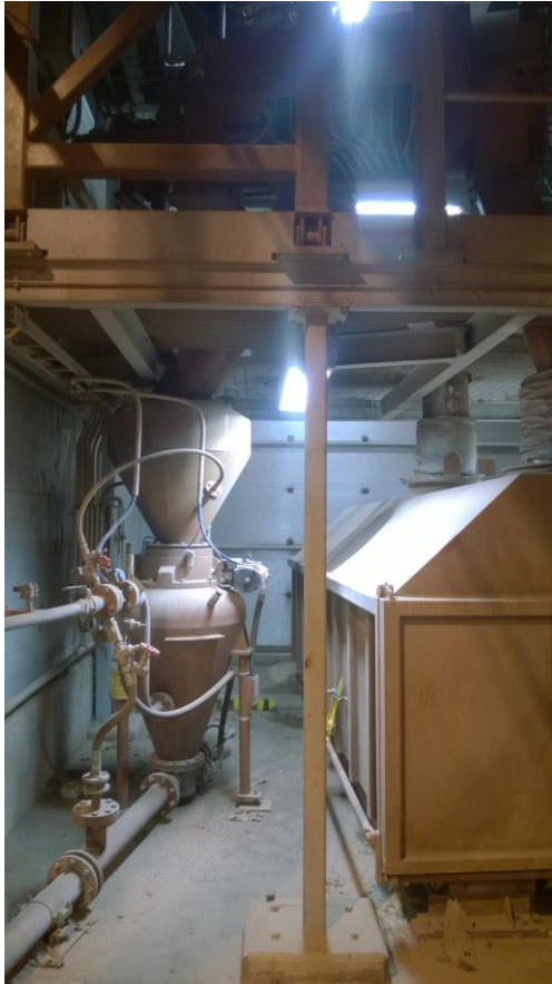
Kuva 6 Hiekan palautuslähetin, Kattilalaitos Satakunnassa (kuva Petri Niemi)
