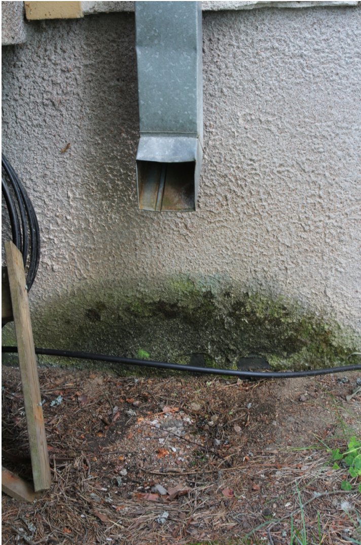
Kuva 8. Terveystalon sadevesijärjestelmän puutteet
