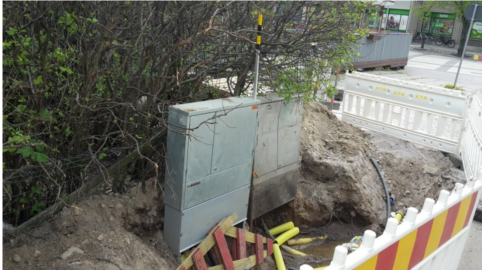
Kuva 16 Sähkökaappi, jolle on myönnetty sijoituslupa ja kaivulupa (Koskela 2017)
